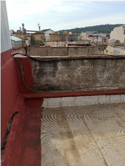
Detall del minvell perimetral on ja s'han fet actuacions de pintat amb "clorocaucho", els paraments dels ampits mostren un important estat de degradació per la falta de goteró de la coronació.
