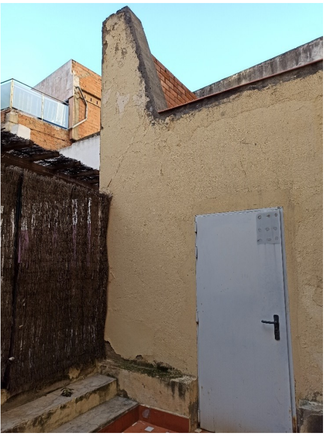
Paraments arrebossats del pati de planta Baixa amb presència de fisuració i humitat.
