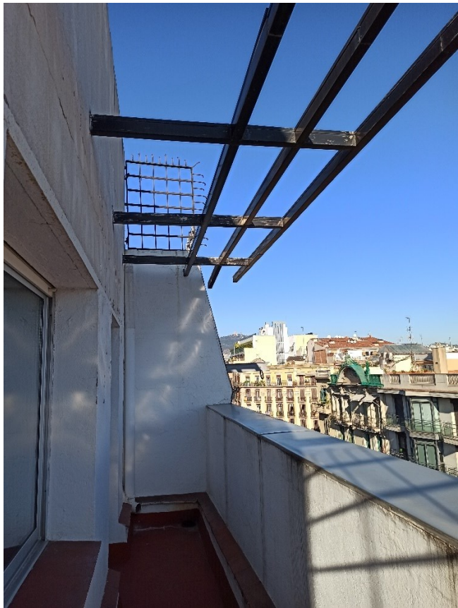
Pèrgola d'alumini que corona la façana del carrer Viladomat. Està conformada per xapa d'alumini reblonada, presenta desperfectes perquè s'ha pintat directament sobre la xapa d'alumini anoditzat amb una pintura a l'esmalt sense preparació de la superfície.
