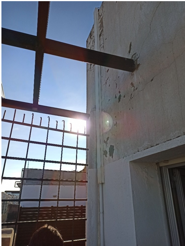
A la fotografia també s'observa, l'estat dels paraments estucats, amb fisures als dintells i a l'encontre amb el forjat. L'ampi de coberta també presenta patologies per l'acció de la humitat degut a que la peça de coronament no té goteró.
