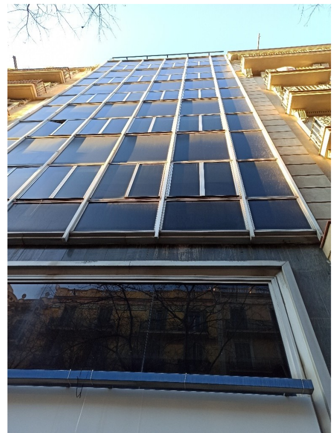
El mur cortina existent presenta diverses patologies per la seva falta d'estanqueïtat El mur cortina és dels anys seixanta, amb una perfil·leria d'alumini, molt elemental i el vidre de tot el tancament és un vidre senzill.
