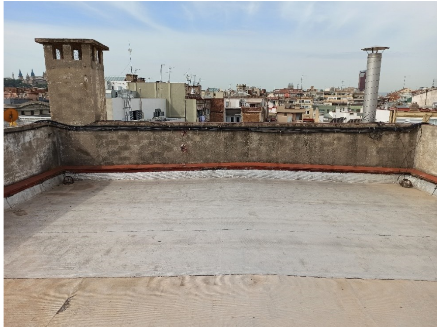
Estat actual de la làmina impermeable autoprotegida acabada amb alumini de la banda sud de la coberta. Mostra un estat d'important degradació.
