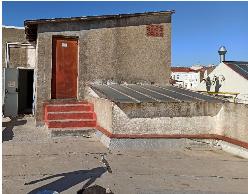
La coberta de la banda de Viladomat mostra les mateixes patologies derivades de l'estat de conservació
