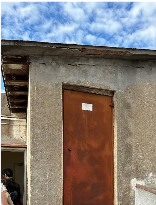
Estat del paraments i sostre del badalot de l'ascensor a rehabilitar.
