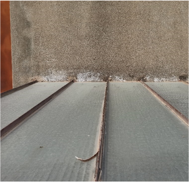
El lluernari format per perfils d'hacer en T i vidres armas, té mostres d'oxidació i alguns dels vidres armas están trencats i caldria substituir-los
