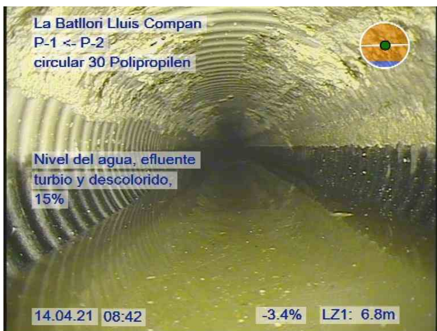
Tramo 1_1da0c140-b0ea-4e6c-80aa-a43995aa3d5f_20210414_084240_938.jpg, 00:01:08, 6.80m Nivel del agua, efluente turbio y descolorido, 15%
