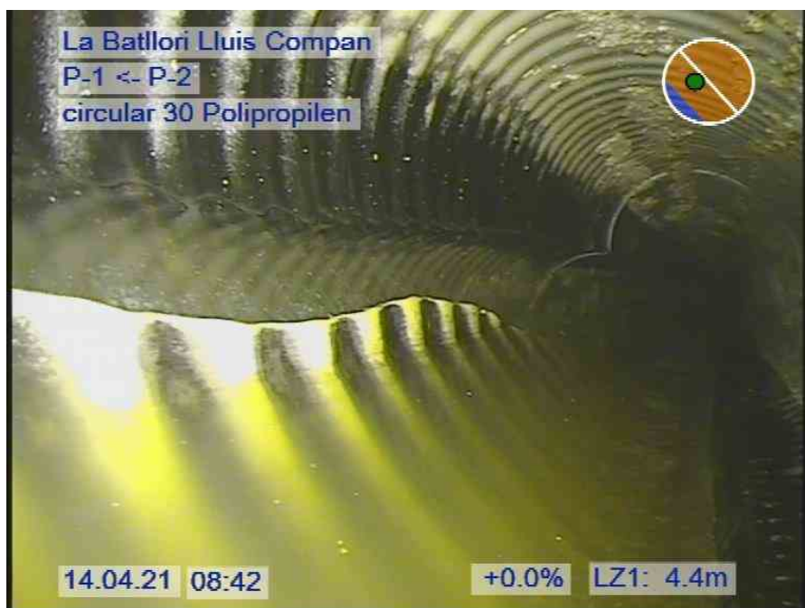
Tramo 1_0821714d-b8a6-4bc8-8d66-d3951d4958fd_20210414_084201_074.jpg, 00:00:44, 4.40m Rotura, fragmentos de la tubería visiblemente desplazados pero no perdidos,, 10mm a 7 Reloj
