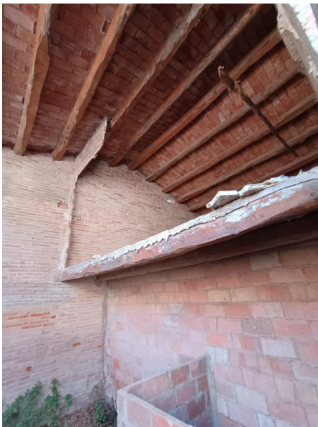
Fotografia 6. Vista on s'aprecia el col·lapse de l'envà de planta primera.
