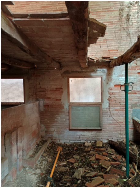
Fotografia 7. Vista on s'aprecia el col·lapse de part del forjat de planta primera.
