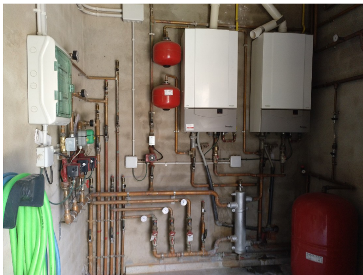
Figura 2.- Sala de calderes existent a la llar d'infants el Niu.
