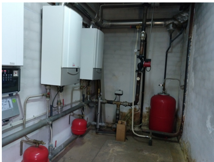
Figura 3.- Sala calderes existent escola el Castanyer.
