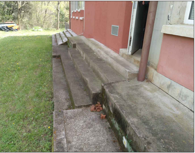
Imatge 4.- Entrada sala de calderes de l'escola
