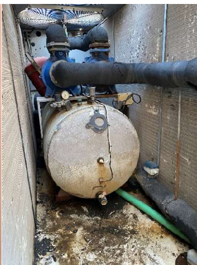
Interior bomba de calor
