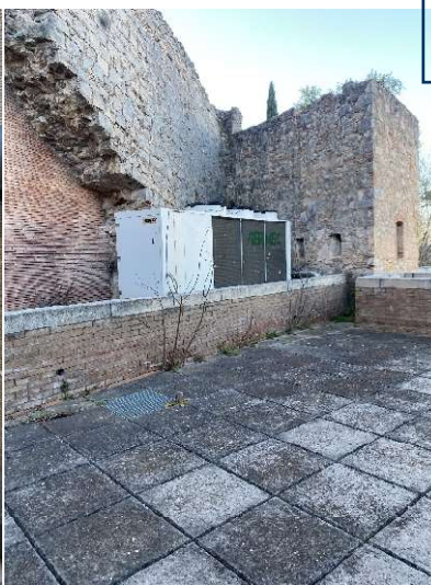
Bomba de calor existent
