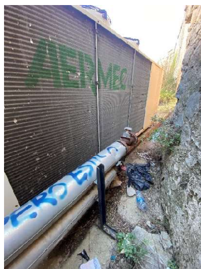
Instal.lació bomba calor existent
