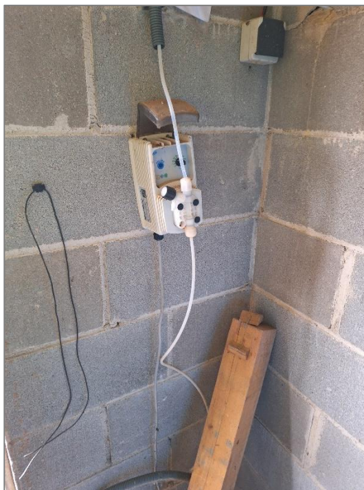
Dosificadora existent fora de servei i avariada
