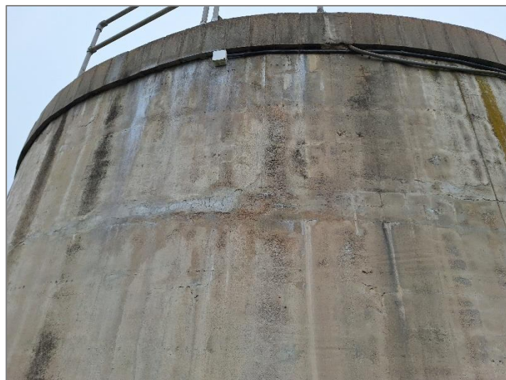
Detall pèrdues cap a exterior de la paret del Dipòsit
