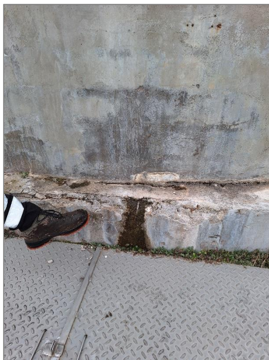
Detall pèrdues a la base del Dipòsit
