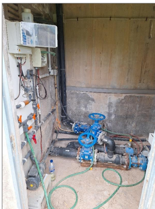
Analitzador de clor en continu existent i fora de servei
