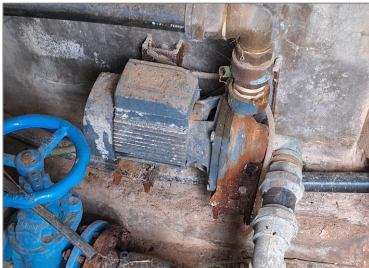
Corrosió en la bomba de Santa Creu
