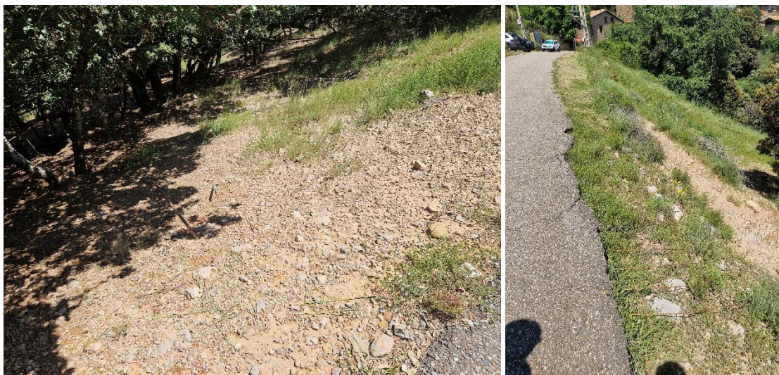
Imatge 03. Aflorament de ferralla i elements perillosos
