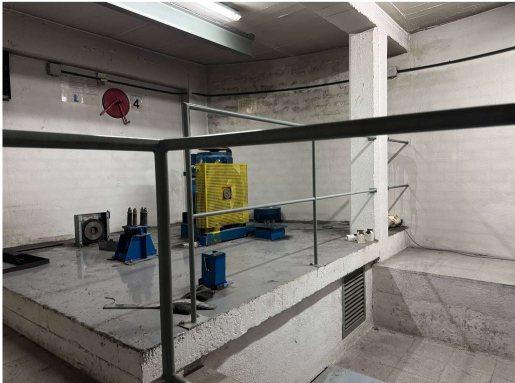
MOTOR ASCENSOR 2 SOBRE ÀTIC
