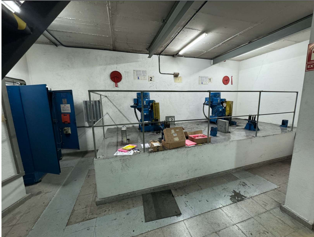
MOTORS ASCENSOR 3 I 4 ÀTIC
