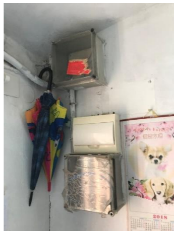
I-ELE – Instal·lació elèctrica comunitària
