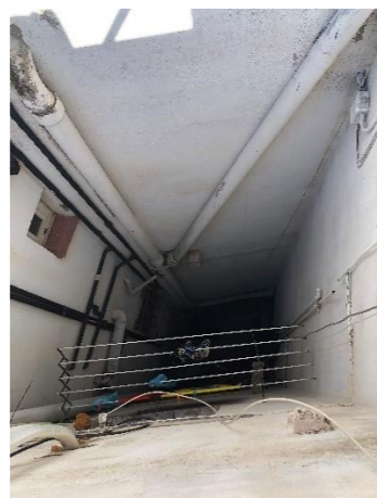
I-EVA – Baixants de sanejament de fibrociment
