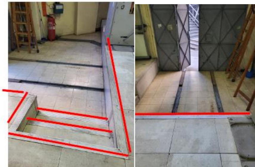
Imatge 27 Desnivell subestació Sarrià
