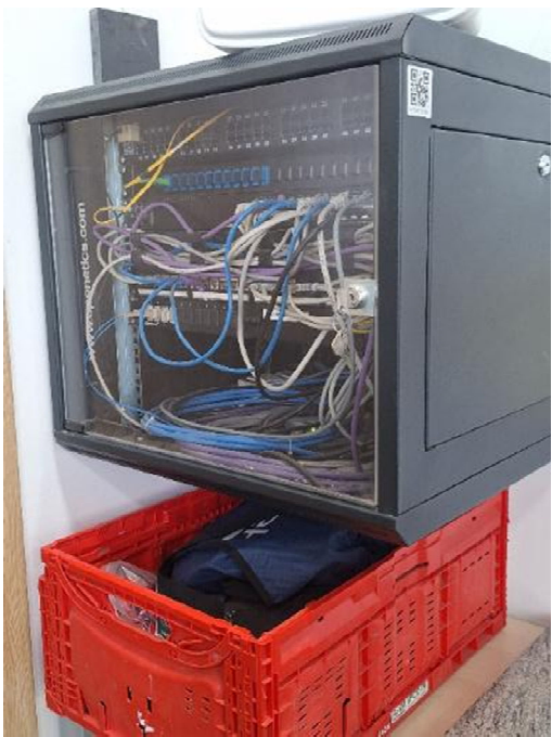
Il·lustració 79 Rack existent Edifici C
