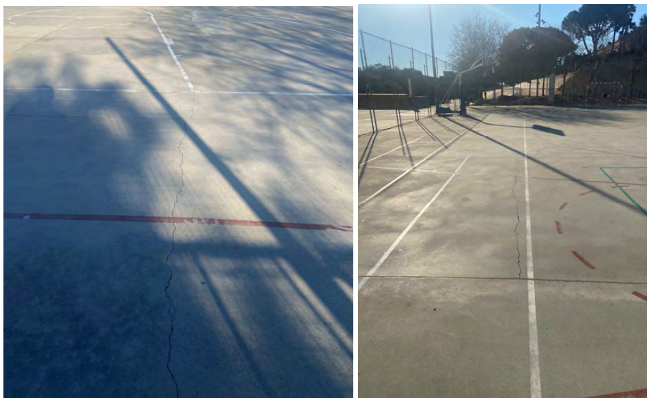
Imatge 7-2. Fissura a tota la longitud de la pista (Windmill)
