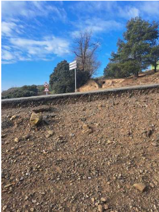
punt 15 (escullera on s'aprecia el descalçat del vial) i l'esglaió que provoca accidents)
