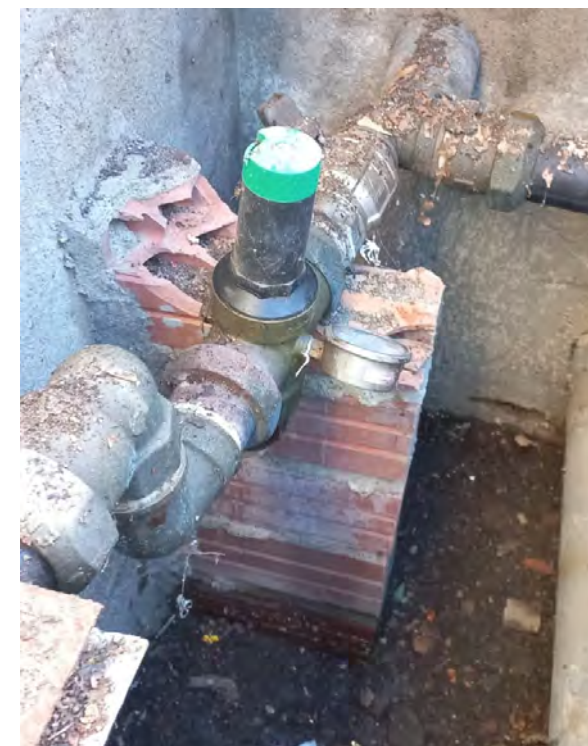
Figura 23. Vàlvula reguladora de pressió Avinguda Rambla Catalunya, 26
