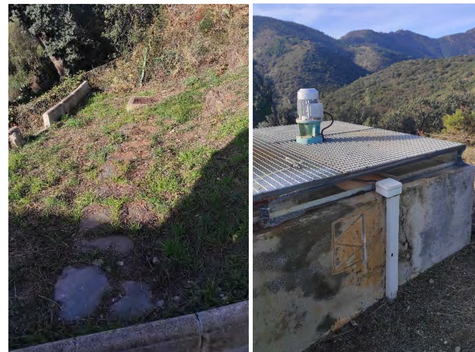
Figures 9 i 10. Àmbit canonada arribada del pantà (1), airejador (2).
