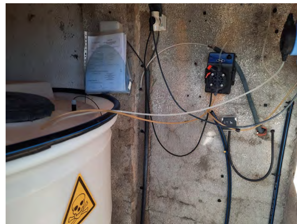
Figura 15. Sistema de cloració.
