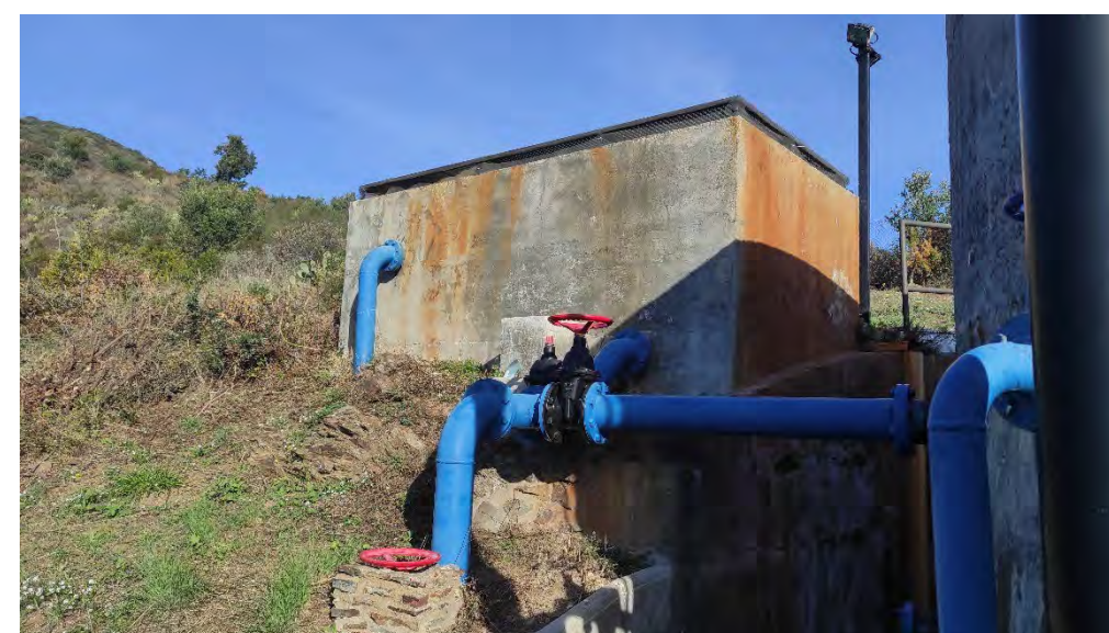
Figura 11. Canonada de l'airejador al decantador.
