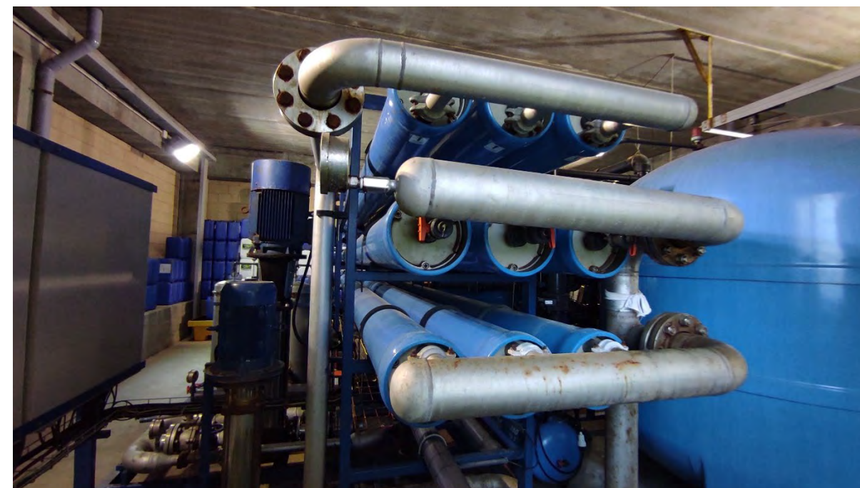
Figura 19. Membranes d'osmosi inversa.
