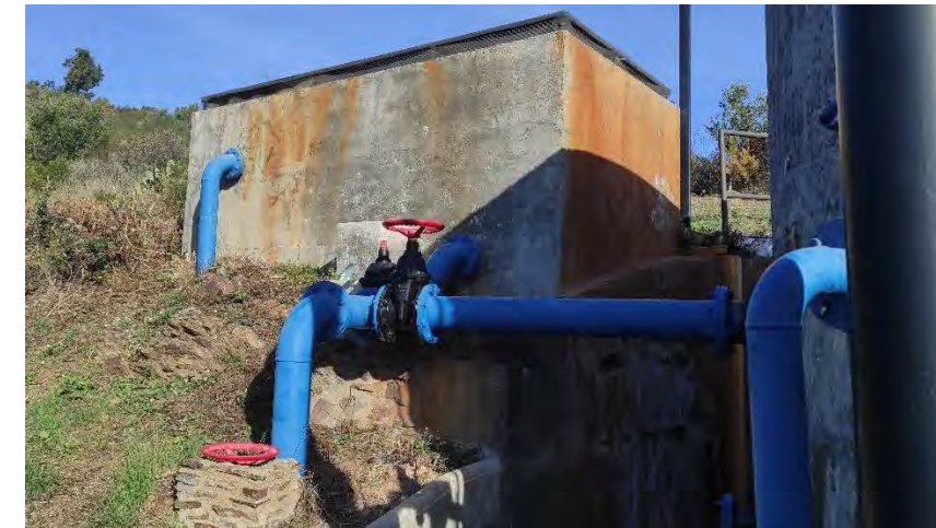
Figura 8 - Conducció del airejador al decantador.
