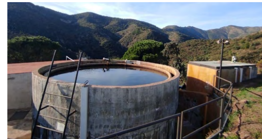
Figura 9 - Decantador de l'ETAP.
