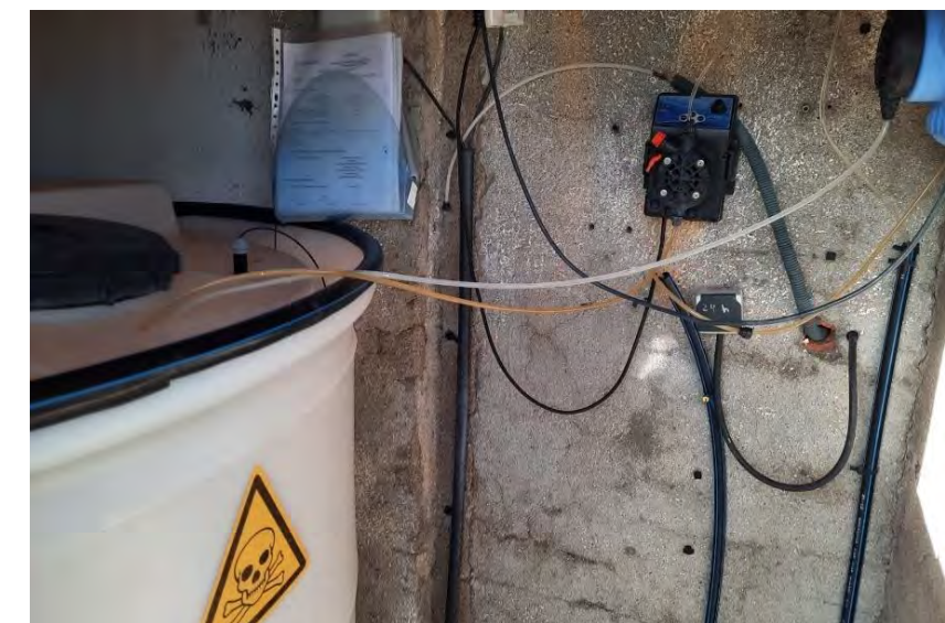
Figura 10 - Sistema de cloració.
