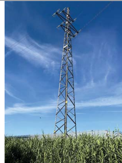
Figura 12: Torre metàl·lica existent MT a connectar amb la futura estesa soterrada 240 Al.
