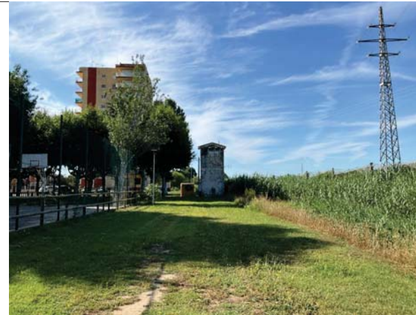
Figura 11: Torre metàl·lica existent MT.
