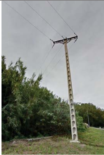
Figura 6: Suport de formigó MT existent de la LAMT.
