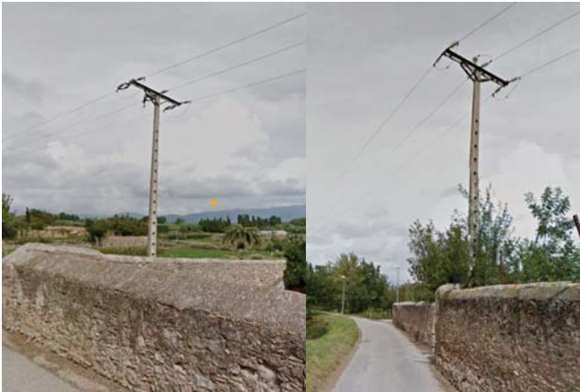
Figura 3: Suports de formigó MT existents de la LAMT..
