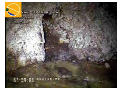
26642_433444cf-aea7-4712-8296-260bf8c23879_20220627_114508_979.jpg, 00:04:25, 16.60 Fotografía general, desde 3 Reloj a 6 Reloj / ROTURA EN JUNTA
