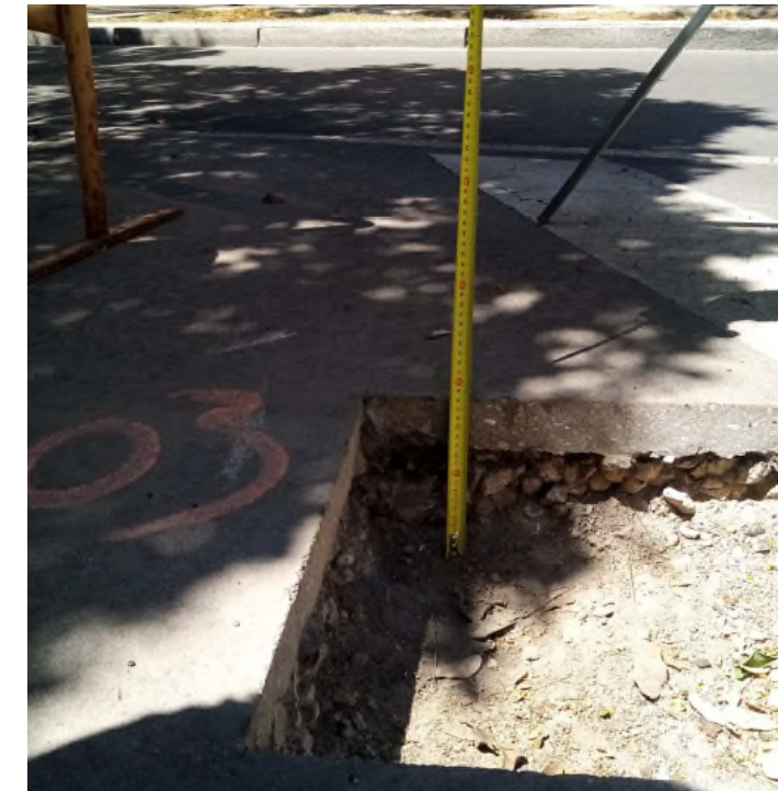
Figura 1: Detall d'una de les cales per la calçada actual.
