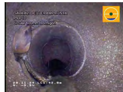
P9 A P10_ee266ce9-b298-41fd-8a8d-fd77c3362ded_20241129_10 4844_723.jpg, 00:04:18, 42.80m Unión, conexión abierta., altura: 81mm, anchura: 81mm a 10 Reloj
