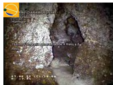
26642_0b748e26-3023-4648-980f-37e7c745f894_20220627_14610_678.jpg, 00:05:38, 19.60 Fotografía general, desde 4 Reloj a 8 Reloj / ROTURA EN JUNTA
