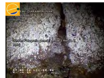
26642_03ac94e8-89c1-4ab0-a484-6ba1b03b83c7_20220627_115044_240.jpg, 00:08:11, 30.90 Fotografía general, desde 3 Reloj a 9 Reloj / ROTURA EN JUNTA
