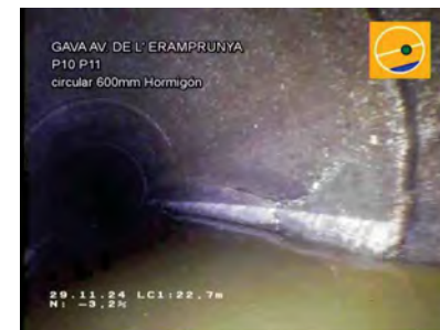
P10 A P11_80a7ce8f-abd9-4e6d-b872-d83317f3e99c_20241129_101923_657.jpg, 00:02:30, 21.70m Fotografía general, a 12 Reloj / INICIO GRIETAS
