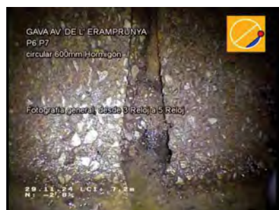
P6 A P7_7ee23577-b841-4f40-80ae-388e8114ff5d_20241129_084917_508.jpg, 00:01:13, 7.20m Fotografía general, desde 3 Reloj a 5 Reloj / JUNTA ABIERTA + GRIETA
