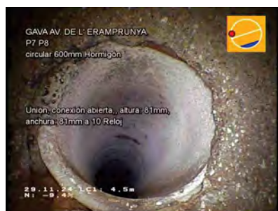
P7 A P8_f34665b0-6be0-401c-9726-ffc895194a91_20241129_0858 25_934.jpg, 00:00:47, 4.50m Unión, conexión abierta., altura: 81mm, anchura: 81mm a 10 Reloj
