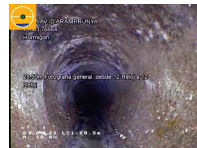
26646_62a94b66-3f71-44fc-96cb-f9793c0501dc_20220627_140400_149.jpg, 00:04:25, 28.50 Fotografía general, desde 12 Reloj a 12 Reloj / DESGASTE
