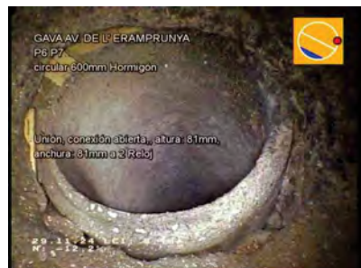
P6 A P7_c0413229-e135-4b99-96d0-a952e380085f_20241129_084833_944.jpg, 00:00:40, 6.70m Unión, conexión abierta., altura: 81mm, anchura: 81mm a 2 Reloj
