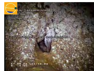
26643_01da3103-656b-4b6f-af69-439fb24a860c_20220627_121529_859.jpg, 00:03:19, 12.20 Fotografia general, desde 3 Reloj a 9 Reloj / ROTURA EN JUNTA
