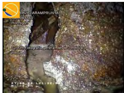
26642_a586af61-624d-4ab0-a528-8d2f6596dd9a_20220627_115142_276.jpg, 00:08:37, 32.90 Fotografía general, desde 3 Reloj a 9 Reloj / FILTRACIÓN Y ROTURA EN JUNTA
