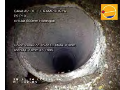
P9 A P10_e0e2a9c4-5c97-41cd-a199-e7f25c050a16_20241129_104403_421.jpg, 00:00:19, 3.70m Unión, conexión abierta,, altura: 81mm, anchura: 81mm a 9 Reloj
