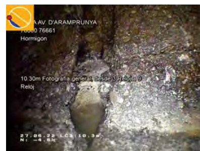
26643_6e778806-461a-4f19-8b1a-3a5451ec3be8_20220627_121454_251.jpg, 00:02:52, 10.30 Fotografia general, desde 3 Reloj a 9 Reloj / ROTURA EN JUNTA
