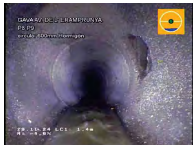
P8 A P9_5c22045d-5ca7-470f-83a2-bbf96ac5443_20241129_090 501_942.jpg, 00:00:07, 1.40m Unión, conexión abierta., altura: 81mm, anchura: 81mm a 2 Reloj
