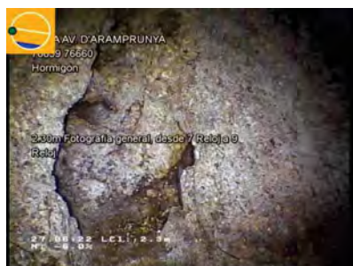
26642_6e162ab5-aa82-40d2-8abb-2dcd7962924b_20220627_113842_942.jpg, 00:00:51, 2.30 Fotografía general, desde 7 Reloj a 9 Reloj / ROTURA EN JUNTA
