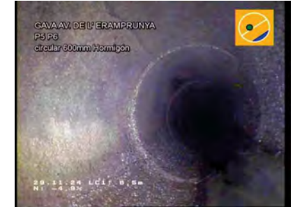
P5 A P6_b96c0547-2f5c-4dee-a394-0875a831042d_20241129_083 342_301.jpg, 00:00:51, 6.50m Fotografía general, desde 12 Reloj a 3 Reloj / INICIO GRIETAS
