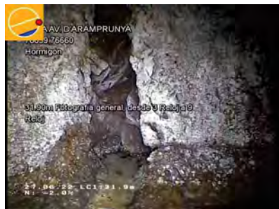
26642_df82ba65-339c-4757-b933-f0ed5dfa1b5f_20220627_115105_936.jpg, 00:08:24, 31.90 Fotografía general, desde 3 Reloj a 9 Reloj / ROTURA EN JUNTA
