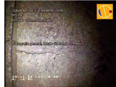
P5 A P6_fa84fec4-7546-4b54-91c0-8c2bb1c2c6cc_20241129_0833 34_799.jpg, 00:00:51, 6.50m Fotografía general, desde 12 Reloj a 3 Reloj / INICIO GRIETAS
