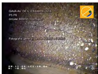
P5 A P6_2b3247ec-2af9-4cfd-8ee5-fe6036c178e6_20241129_083554_156.jpg, 00:02:41, 18.00m Fotografía general, desde 4 Reloj a 5 Reloj / JUNTA ABIERTA + GRIETA
