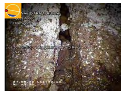
26642_0525706f-433e-4350-af9f-c02460bb2ef2_20220627_115018_929.jpg, 00:07:57, 30.10 Fotografía general, desde 3 Reloj a 9 Reloj / ROTURA EN JUNTA
