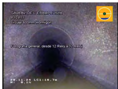
P10 A P11_df951784-e9ab-43e9-afc2-5af0833a53c5_20241129_101832_138.jpg, 00:01:59, 16.70m Fotografía general, desde 12 Reloj a 12 Reloj / FINAL GRIETAS
