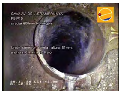
P9 A P10_d718756c-4012-4650-925a-fdaaa65cdf35_20241129_10 4836_231.jpg, 00:04:18, 42.80m Unión, conexión abierta., altura: 81mm, anchura: 81mm a 10 Reloj
