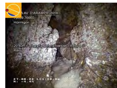
26642_35527629-dd63-4313-b662-7311bc24bb1a_20220627_14653_351.jpg, 00:06:00, 20.80 Fotografía general, desde 3 Reloj a 9 Reloj / ROTURA EN JUNTA
