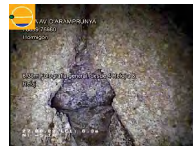
26642_09fd9aa8-d199-4b7a-ba0d-2425fc4aaae7_20220627_114052_809.jpg, 00:01:52, 6.30 Fotografía general, desde 4 Reloj a 8 Reloj / ROTURA EN JUNTA
