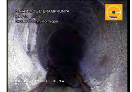
P9 A P10_9b9c0d75-db6e-42e1-9d2a-87f606099d01_20241129_104410_370.jpg, 00:00:19, 3.70m Unión, conexión abierta,, altura: 81mm, anchura: 81mm a 9 Reloj
