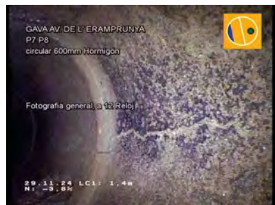
P7 A P8_5f665170-23fc-4d57-909e-048323f4748_20241129_0857 31_991.jpg, 00:00:10, 1.40m Fotografía general, a 12 Reloj / INICIO GRIETA
