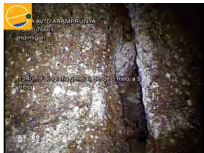
26643_a16a9c7f-ae70-4bf3-92a6-d0d945c60efb_20220627_121557_927.jpg, 00:03:37, 13.40 Fotografía general, desde 3 Reloj a 9 Reloj / ROTURA EN JUNTA
