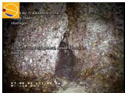
26642_d8e25fea-9e02-4406-b7c2-18bafb5524a0_20220627_114729_936.jpg, 00:06:23, 22.80 Fotografía general, desde 4 Reloj a 8 Reloj / ROTURA EN JUNTA
