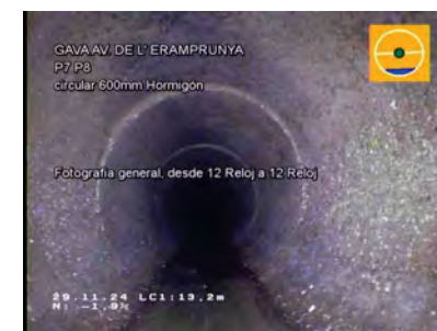
P7 A P8_32e1e0e9-ff5f-4fb9-9ab0-fa74f604846b_20241129_09000 5_207.jpg, 00:02:04, 13.20m Fotografía general, desde 12 Reloj a 12 Reloj / FINAL GRIETAS
