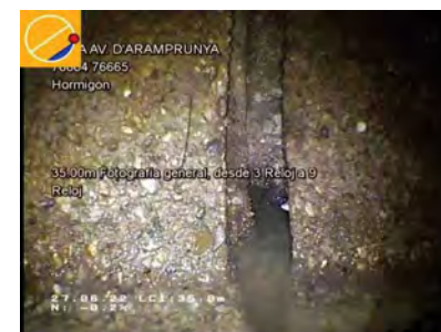
26647_aa30dbc8-46d7-4f98-ab15-d3b951968ab2_20220627_143854_627.jpg, 00:03:26, 35.00 Fotografía general, desde 3 Reloj a 9 Reloj / JUNTA ABIERTA
