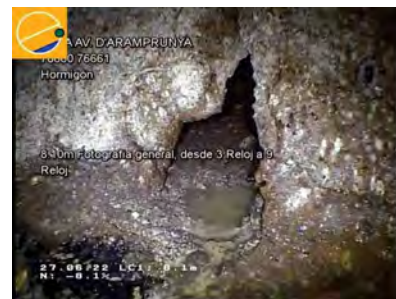
26643_cf822d3a-b36a-4121-8803-09dd3ae8797b_20220627_121357_709.jpg, 00:02:13, 8.10 Fotografia general, desde 3 Reloj a 9 Reloj / ROTURA EN JUNTA
