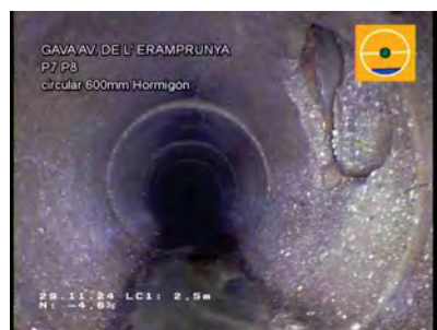
P7 A P8_fdb11899-a51e-4ffc-a53a-413c625c8eb7_20241129_0857 58_742.jpg, 00:00:21, 2.50m Unión, conexión abierta., altura: 81mm, anchura: 81mm a 2 Reloj
