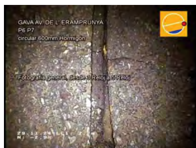
P6 A P7_2ffd0486-d993-4579-96fd-9e98008fc99d_20241129_084921_411.jpg, 00:01:13, 7.20m Fotografía general, desde 3 Reloj a 5 Reloj / JUNTA ABIERTA + GRIETA
