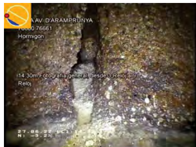
26643_3ca81f47-686f-4e3c-aa9e-15f6f3da2b77_20220627_121638_476.jpg, 00:04:08, 14.30 Fotografía general, desde 3 Reloj a 9 Reloj / ROTURA EN JUNTA
