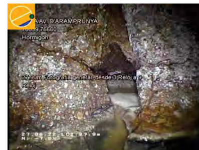
26642_5f36410a-cc1c-4725-ad41-0920cb54eb49_20220627_114927_430.jpg, 00:07:27, 27.90 Fotografía general, desde 3 Reloj a 9 Reloj / ROTURA EN JUNTA
