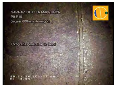
P9 A P10_b34c9c52-a9ac-40ee-ad94-6b136f5a7dea_20241129_10 4548_753.jpg, 00:01:46, 17.00m Fotografía general, a 12 Reloj / INICIO GRIETA
