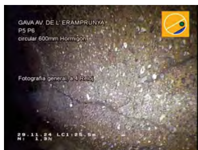
P5 A P6_1f4640f0-9b76-4378-985a-98964c6ae117_20241129_083647_382.jpg, 00:03:28, 25.50m Fotografía general, a 4 Reloj / INICIO GRIETAS
