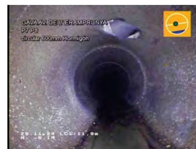
P7 A P8_7b739d38-826b-4beb-a7c4-da0c58bd4712_20241129_08 5937_398.jpg, 00:01:41, 11.90m Unión, conexión abierta., altura: 81mm, anchura: 81mm a 1 Reloj
