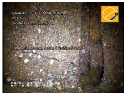
P5 A P6_98180784-6435-4bc6-902a-29405b60e1a6_20241129_083550_609.jpg, 00:02:41, 18.00m Fotografía general, desde 4 Reloj a 5 Reloj / JUNTA ABIERTA + GRIETA
