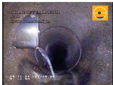
P7 A P8_254b7f03-1918-43d0-a3ae-5fb7e173d032_20241129_090106_143.jpg, 00:02:44, 20.00m Unión, conexión abierta., altura: 81mm, anchura: 81mm a 10 Reloj
