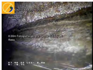
26642_e0bc444d-96df-42f4-b09a-013e7afd697e_20220627_114142_302.jpg, 00:02:22, 8.00 Fotografía general, desde 4 Reloj a 8 Reloj / FISURA
