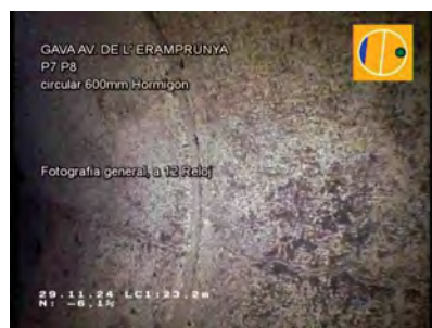
P7 A P8_7511fbaf-2886-41dd-a6c7-a2fb5c1f0d22_20241129_090144_795.jpg, 00:03:16, 23.20m Fotografía general, a 12 Reloj / INICIO GRIETA
