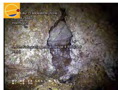
26642_7b73c687-8340-442a-9126-7199676b03c4_20220627_114021_864.jpg, 00:01:39, 5.40 Fotografía general, desde 4 Reloj a 8 Reloj / ROTURA EN JUNTA
