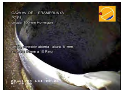
P7 A P8_e1692f7d-bb2d-4257-aca9-42e32888acb0_20241129_090100_965.jpg, 00:02:44, 20.00m Unión, conexión abierta., altura: 81mm, anchura: 81mm a 10 Reloj
