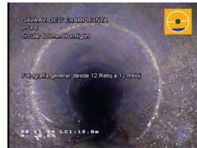
P5 A P6_e56d3a2d-839a-4700-8c79-ae1c4f952a2a_20241129_083 435_410.jpg, 00:01:45, 13.00m Fotografía general, desde 12 Reloj a 12 Reloj / FINAL GRIETAS
