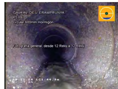
P5 A P6_1a75aa76-45c7-4c13-95ef-b95fd4016f7a_20241129_083951_774.jpg, 00:05:34, 44.30m Fotografía general, desde 12 Reloj a 12 Reloj / FINAL GRIETAS
