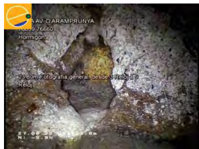
26642_241b71c0-1036-4a00-a4ea-cfa66a607b3e_20220627_114756_378.jpg, 00:06:38, 23.80 Fotografía general, desde 3 Reloj a 9 Reloj / ROTURA EN JUNTA
