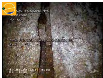
26643_e1aa7355-5da4-4977-a2e5-115ef7097bf2_20220627_121157_083.jpg, 00:00:49, 3.20 Fotografia general, desde 6 Reloj a 10 Reloj / JUNTA ABIERTA
