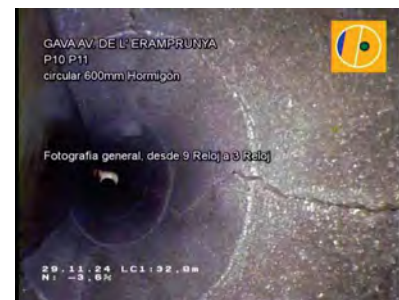
P10 A P11_97c29f4a-9932-47bc-95e8-36794571537a_20241129_102035_704.jpg, 00:03:42, 32.00m Fotografía general, desde 9 Reloj a 3 Reloj / CONTINUACION GRIETAS
