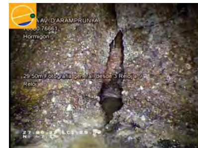
26643_c47321db-5451-4f73-a39d-04e8274d5a62_20220627_122125_129.jpg, 00:08:13, 29.50 Fotografía general, desde 3 Reloj a 9 Reloj / ROTURA EN JUNTA
