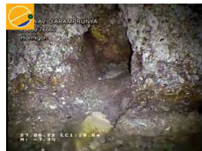
26642_19d9278a-77ae-4d35-8701-d88d833a1670_20220627_14619_662.jpg, 00:04:11, 15.60 Fotografía general, desde 6 Reloj a 8 Reloj / ROTURA EN JUNTA
