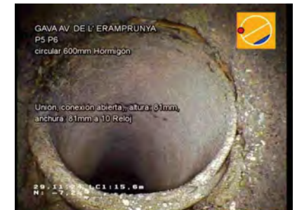
P5 A P6_2494e44f-6ba2-4599-9d42-7306c7739acd_20241129_083 502_642.jpg, 00:02:04, 15.60m Unión, conexión abierta,, altura: 81mm, anchura: 81mm a 10 Reloj
