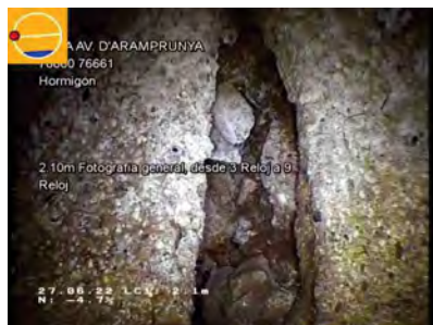
26643_1808bc14-dd50-42a8-b9da-6cff6f25cc31_20220627_12112_621.jpg, 00:00:16, 2.10 Fotografia general, desde 3 Reloj a 9 Reloj / ROTURA EN JUNTA
