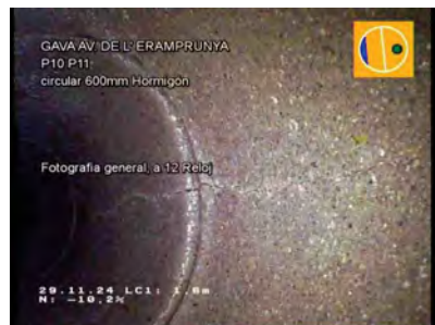
P10 A P11_d2adf102-940b-4bf9-9847-785f10059894_20241129_101624_601.jpg, 00:00:14, 1.60m Fotografía general, a 12 Reloj / INICIO GRIETA
