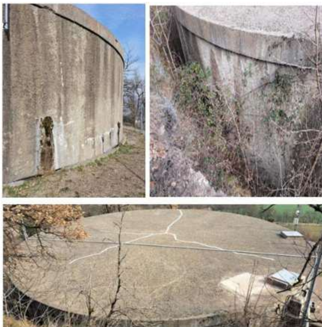
Figura 2. Vista exterior patologies dipòsit de Cussons
