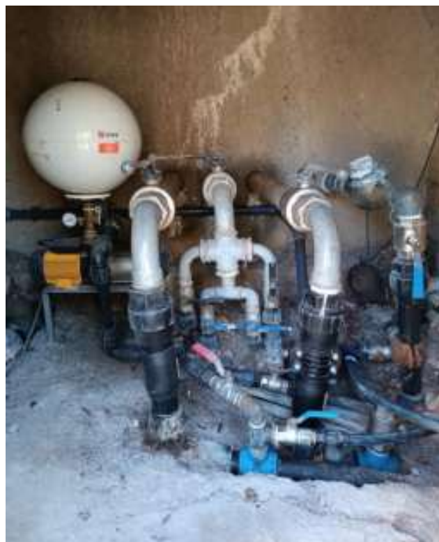
Figura 8. Vista interior caseta de vàlvules (1)
