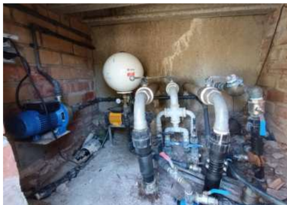
Figura 9. Vista interior caseta de vàlvules (2)
