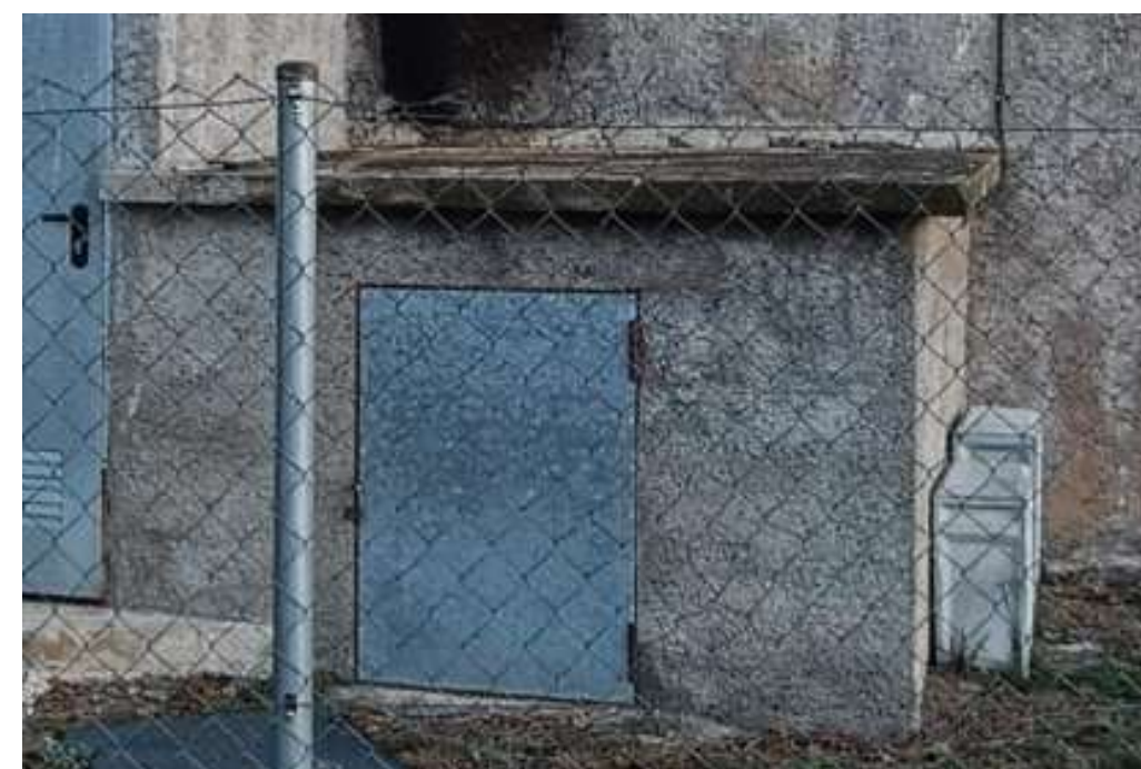
Figura 7. Vista exterior caseta de vàlvules
