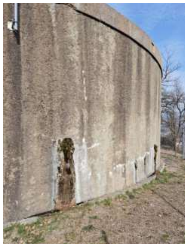
Figura 5. Patologies identificades al dipòsit de Cussons (3)
