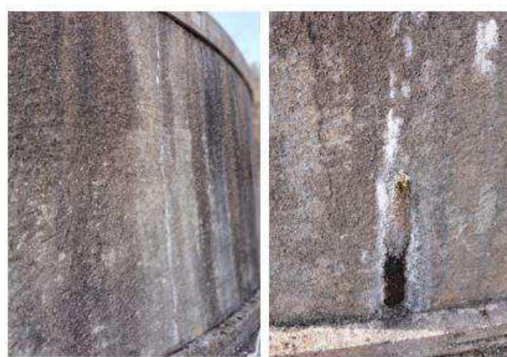
Figura 6. Patologies identificades al dipòsit Cussons (4)
