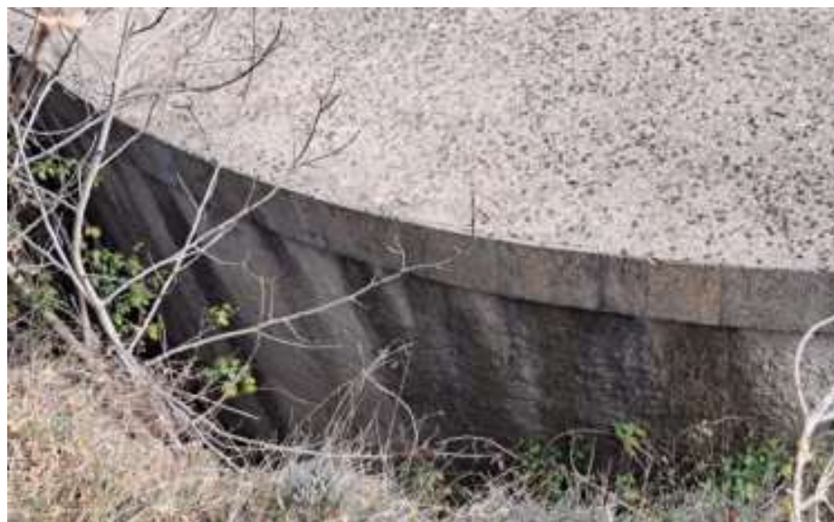
Figura 4. Patologies identificades al dipòsit de Cussons (2)
