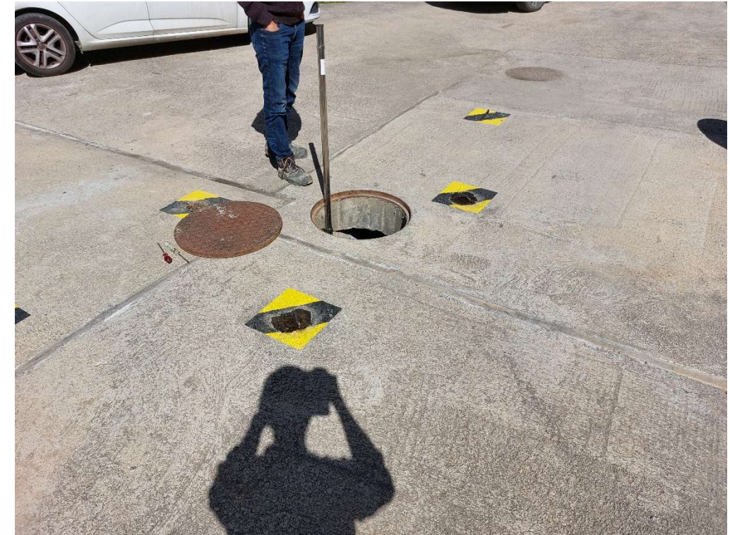
Fotografia 31. Boca d'home d'accés a la cambra de vàlvules de la línia de cabals de manteniment.
