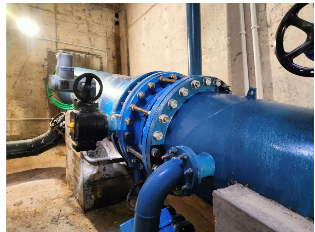
Fotografia 47. Vista de la vàlvula de papallona d'aigües avall a aigües amunt.
