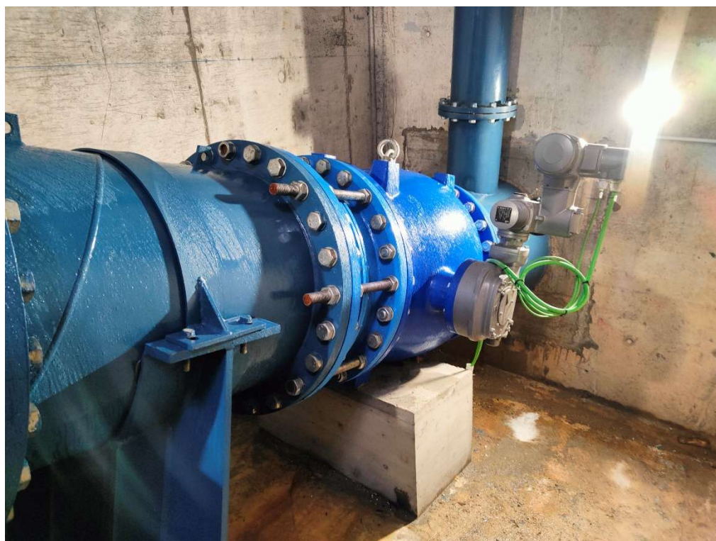
Fotografia 51. Vàlvula de pas anular DN700.
