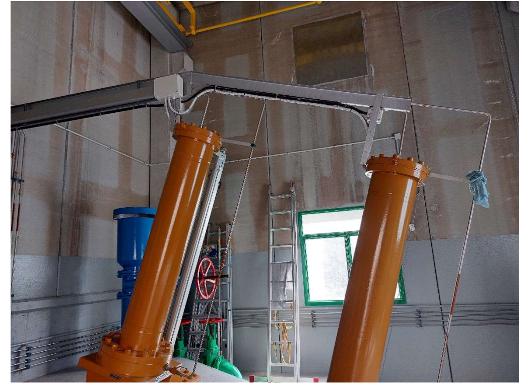
Fotografia 37. Accionament de les vàlvules de comporta del desguàs de mig fons.
