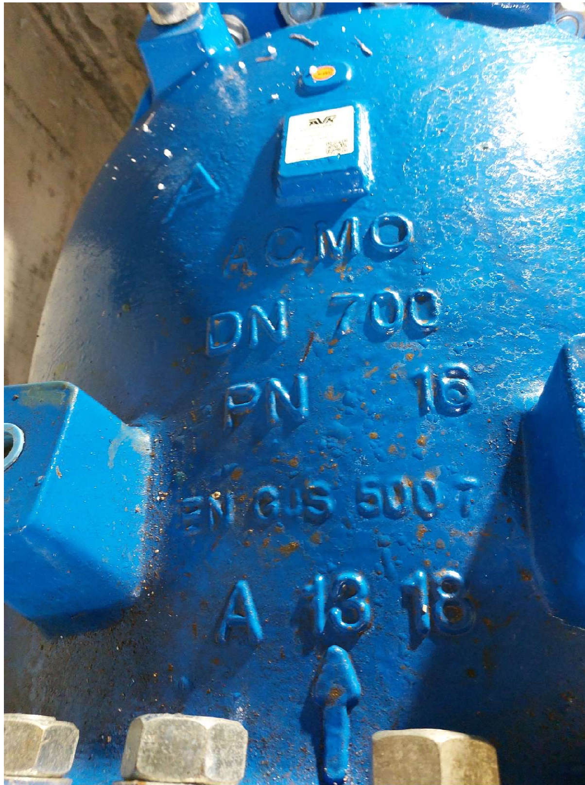
Fotografia 55. Detall vàlvula de pas anular.
