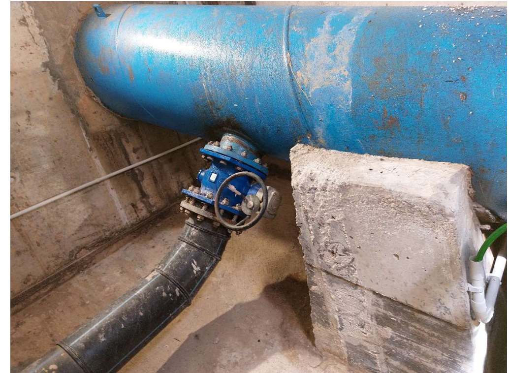
Fotografia 42. Entrada de la conducció a la cambra de vàlvules de la línia de cabals de manteniment
