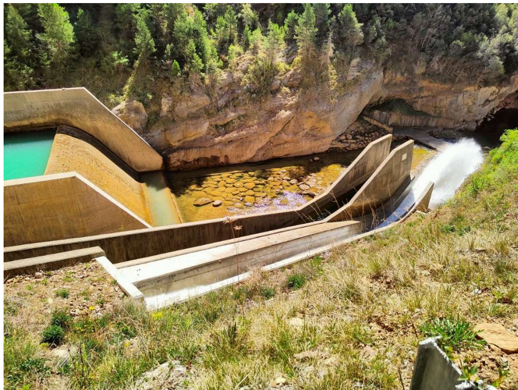
Fotografia 61. Trampolí de sortida de la línia de cabals de manteniment en funcionament.
