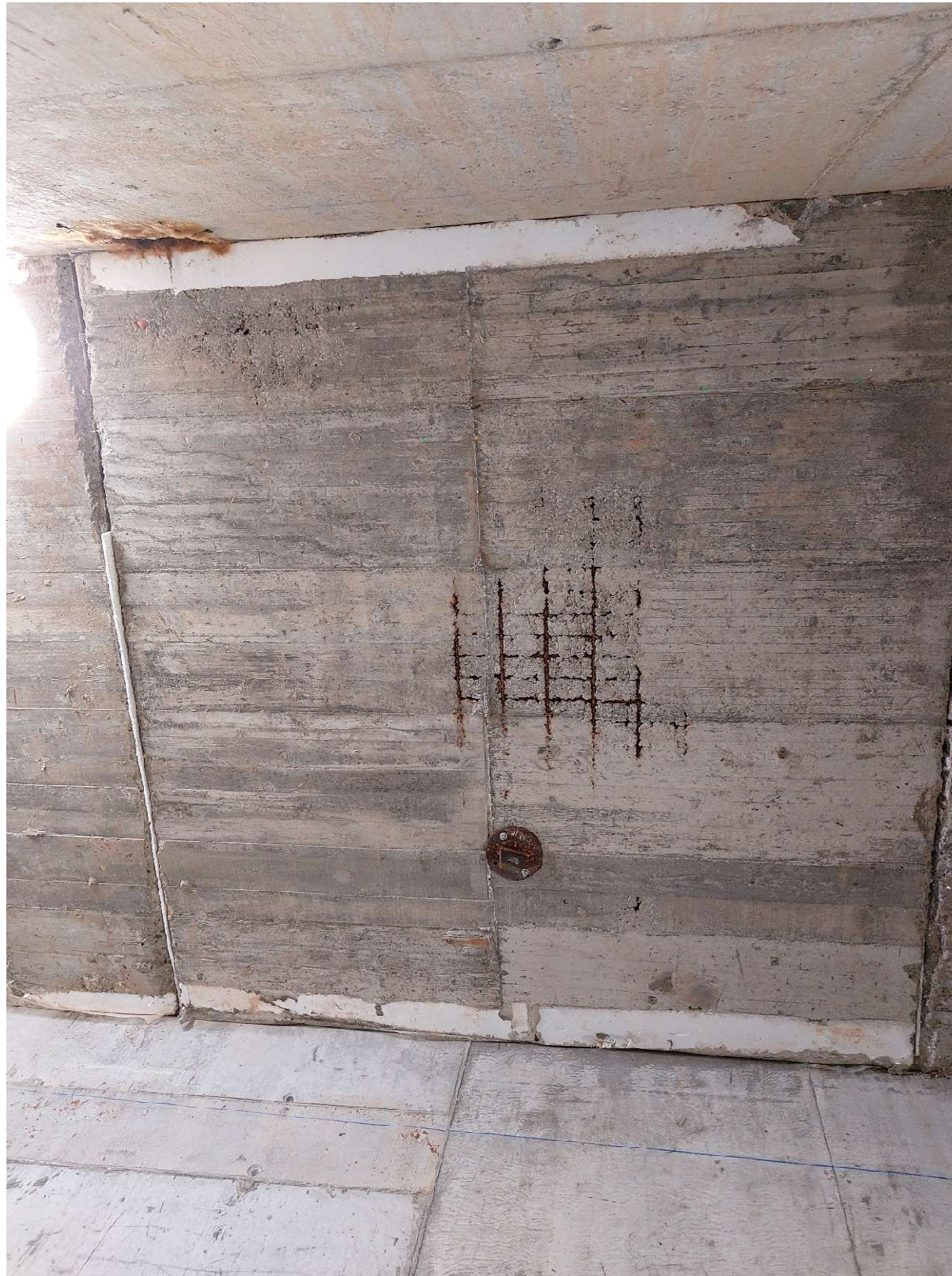
Fotografia 53. Detall fotjat superior de la cambra de vàlvules de la línia de manteniment.
