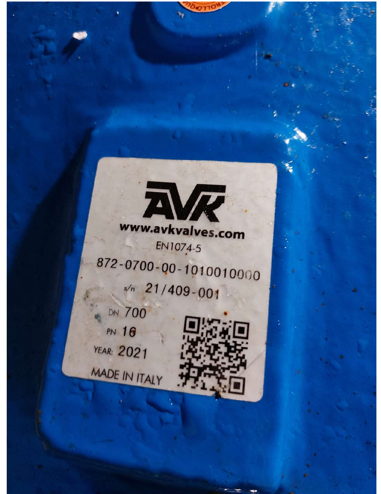
Fotografia 56. Detall vàlvula de pas anular.
