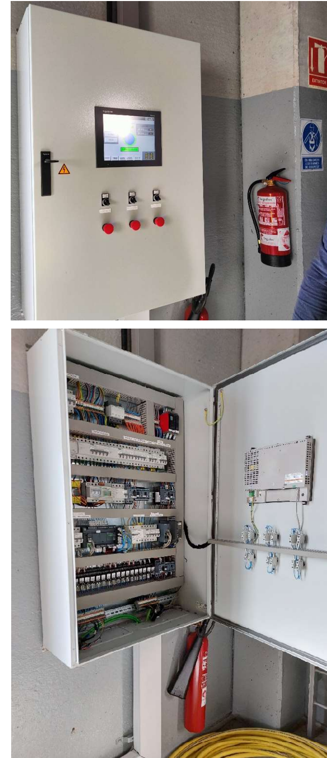
Fotografia 40. Quadre del control de les vàlvules de comporta del desguàs de mig fons.
