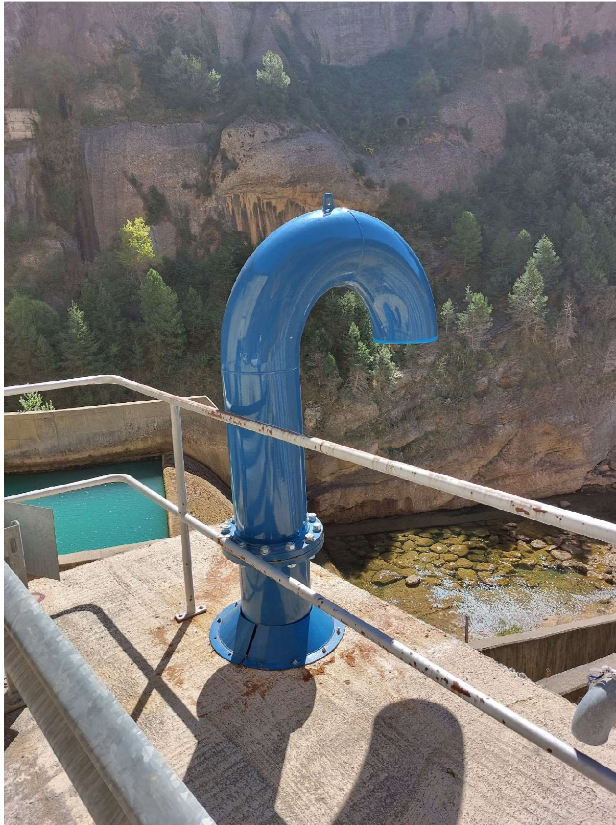
Fotografia 30. Aeració de la transició de la conducció DN700 a la conducció quadrada de 1,2x1,2 m.
