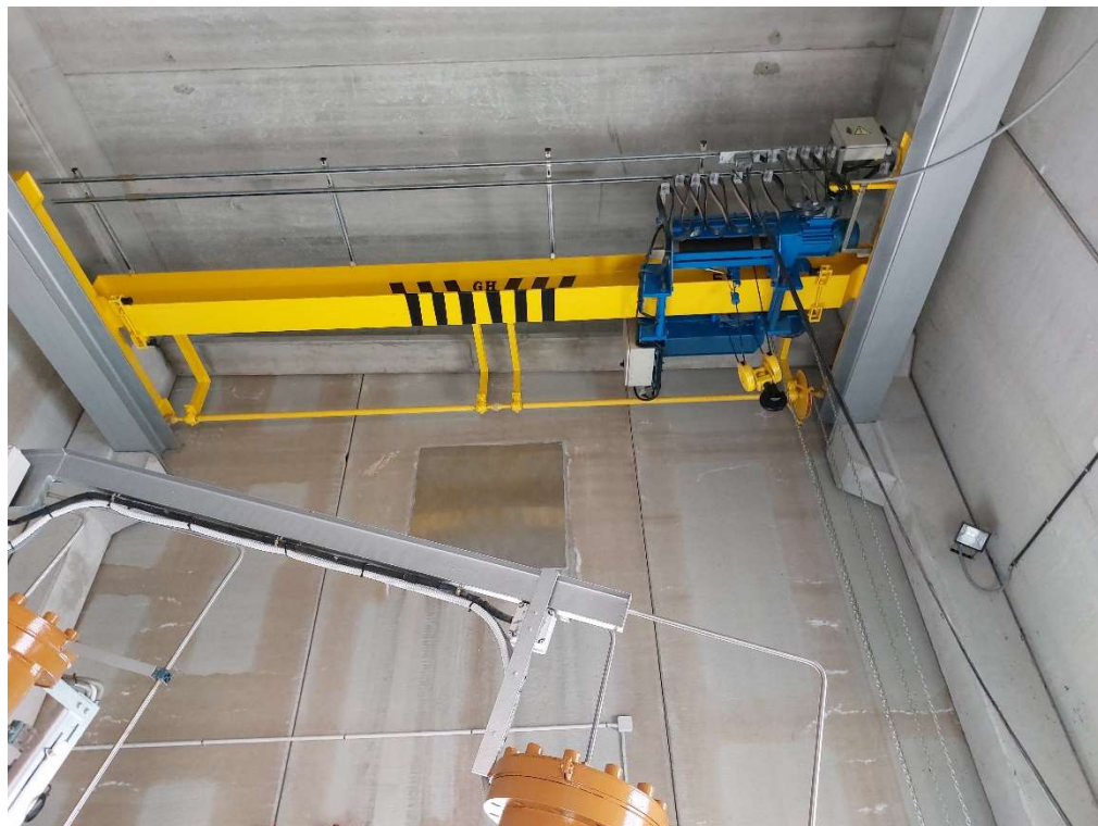
Fotografia 36. Pont grua i polispast de la cambra de vàlvules del desguàs de mig fons.
