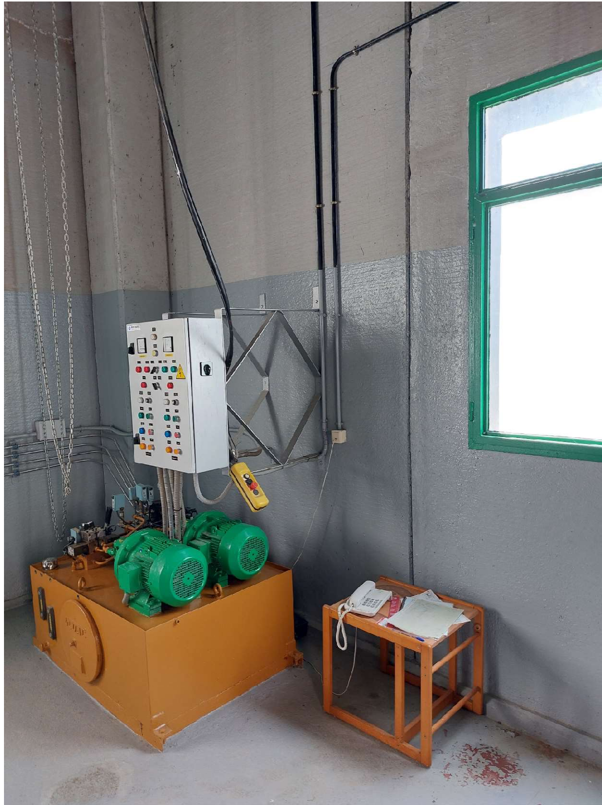
Fotografia 39. Quadre de comandament del grup oleohidràulic de les vàlvules de comporta del desguàs de mig fons.
