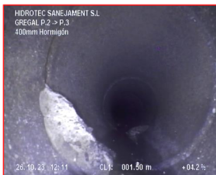
Incrustacion a 1,6 metros
