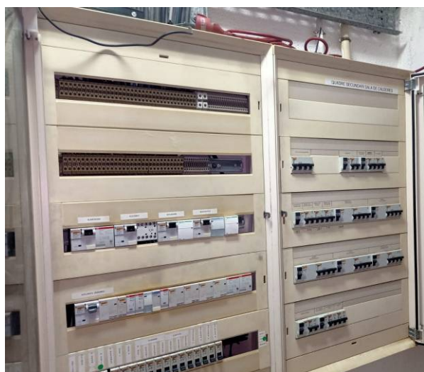
5.- S.Quadre Sala de Calderes
