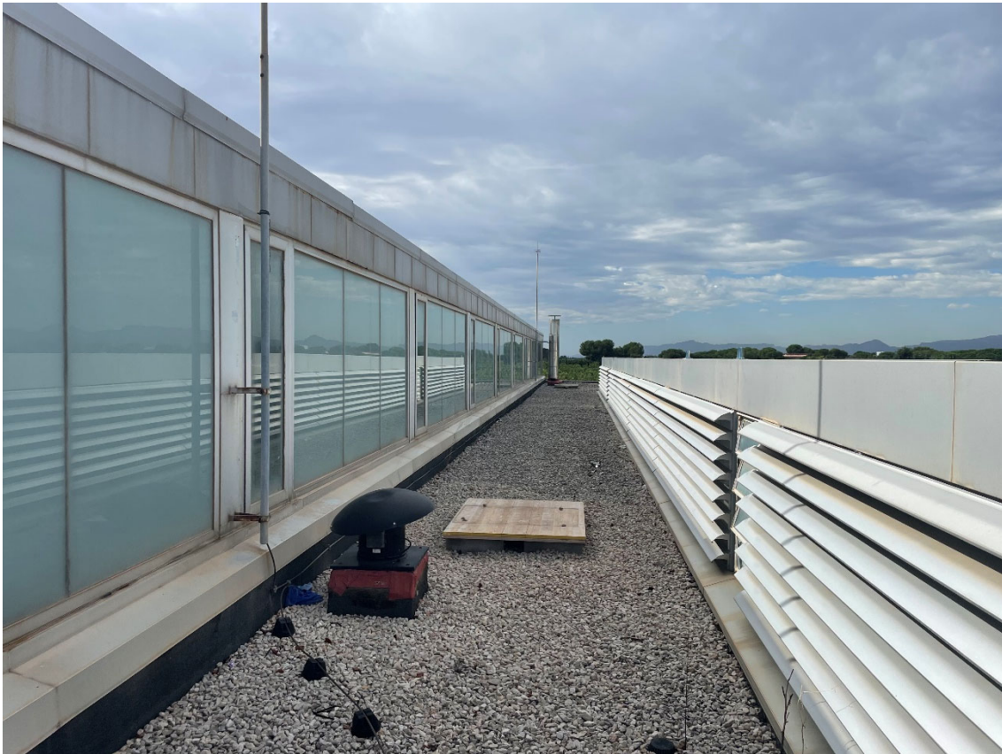
Figura 9 Coberta plana, visita 09/10/2024
