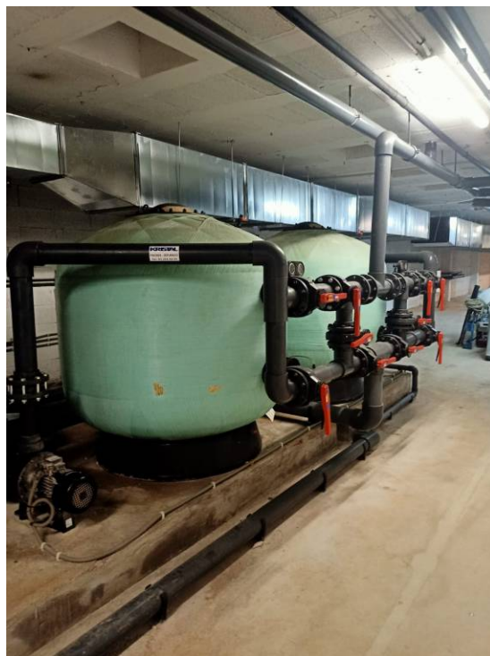
Filtres Piscina Exterior
