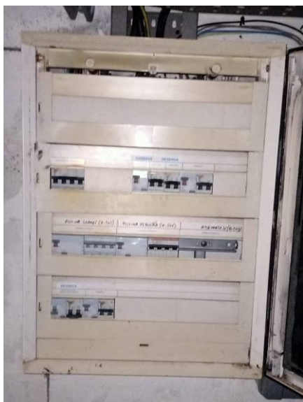
3.-S.Quadre Equip de Filtració
