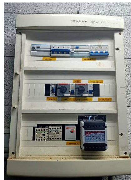
7.- S.Quadre filtració piscina
