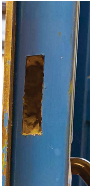
Mostra: 14225085 Porta Emergència Blava (Sala Unió Escales Vidreres)
