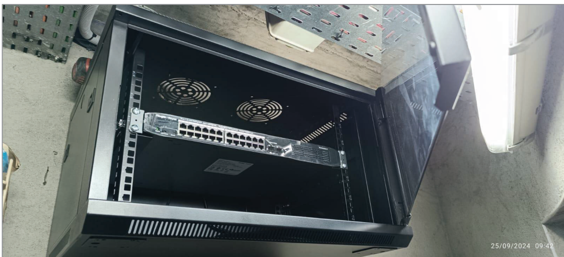
Imatge 8: Rack on es preveu ubicar el videogravador de l'aparcament Miquel de Palol
