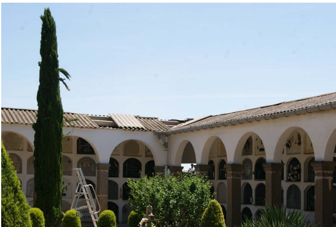
A dalt, vista d'un tram de fals sostre realitzat amb fibrociment amb amiant. A baix vista de diverses cales realitzades a la coberta
