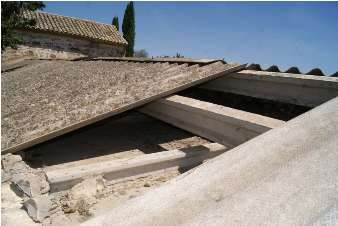
Detall de les cales realitzades al cementiri, observant-se les biguetes prefabricades. S'observen diversos punts d'entrada d'aigua.
