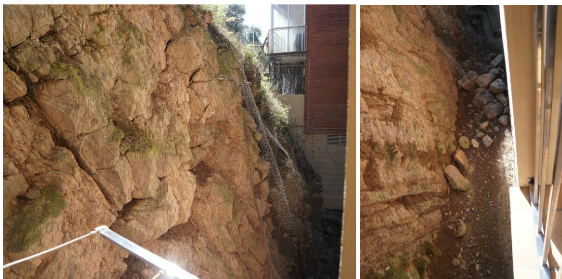
Figura 6. Talús posterior de la finca nº 49. Detall dels blocs acumulats al peu del talús.
