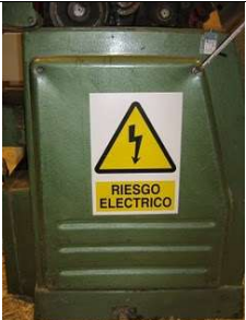
Foto 06: Tots els riscos elèctrics estaran degudament senyalitzats
