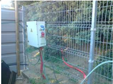
Foto 06: Tindrem cura de les instal·lacions provisionals d'obra.
