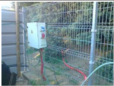
Foto 05: Tindrem cura de les instal·lacions provisionals d'obra.
