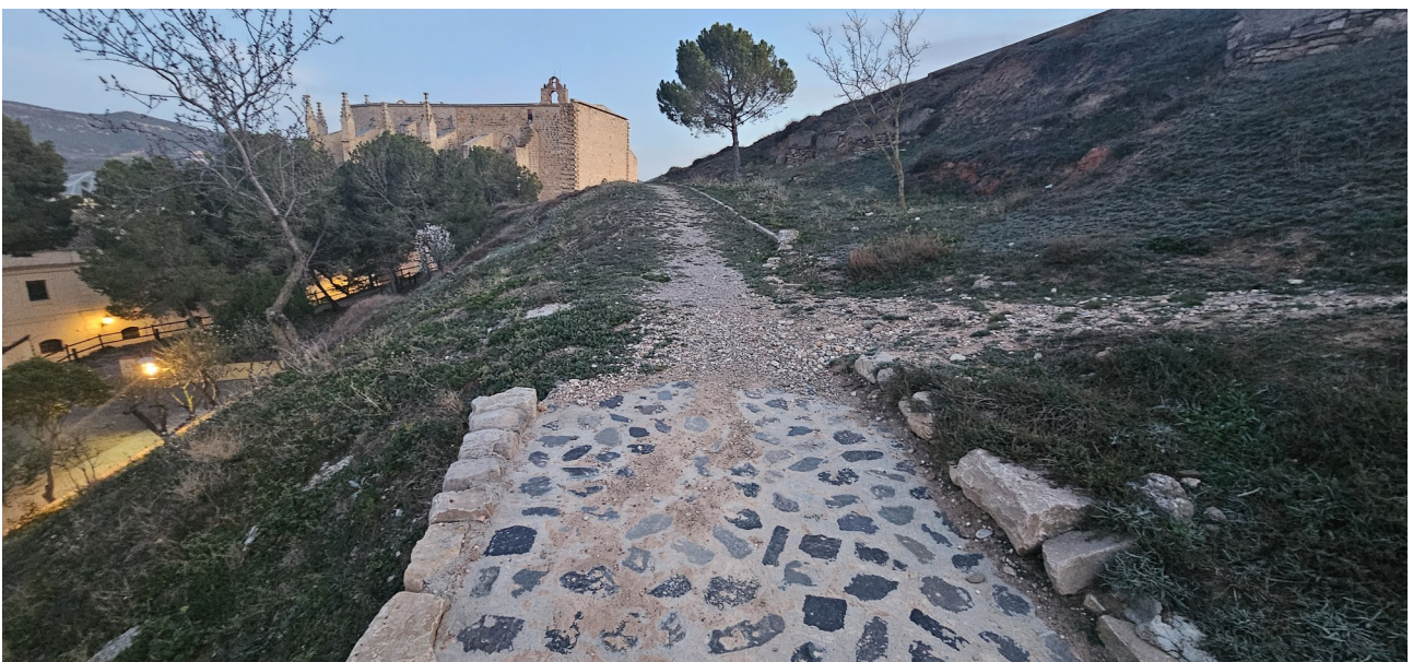
Paviment segur sense continuïtat
