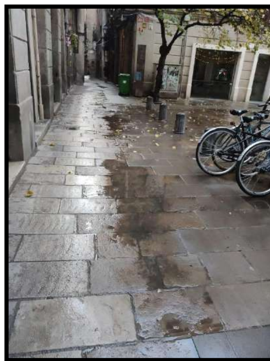
Acumulació d'aigua als aiguafons
