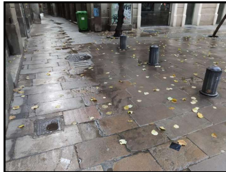
Acumulació d'aigua als aiguafons
