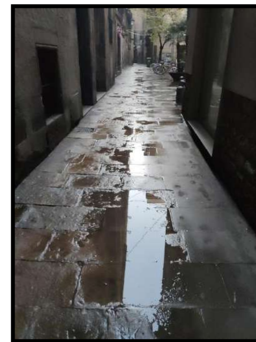
Acumulació d'aigua per imperfeccions del paviment
