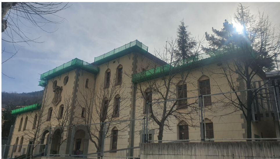
xarxa de protecció perimetral
