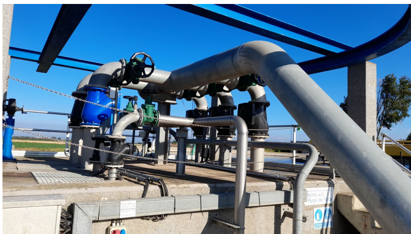
Vàlvules de retenció a substituir
