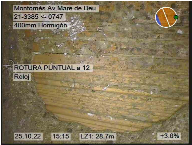
43.jpg, 00:02:38, 28.70m ROTURA PUNTUAL a 12 Reloj
