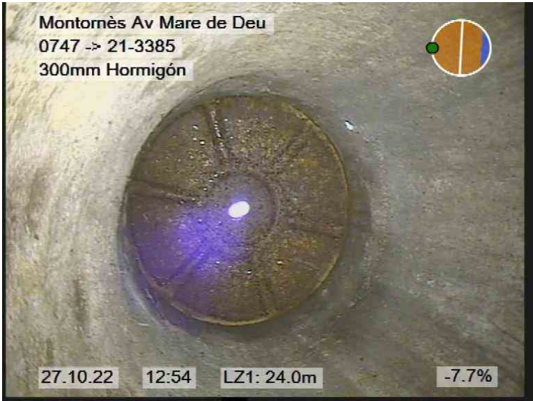
49.jpg, 00:02:29, 24.00m POZO FINAL SIN ACOMETIDAS
