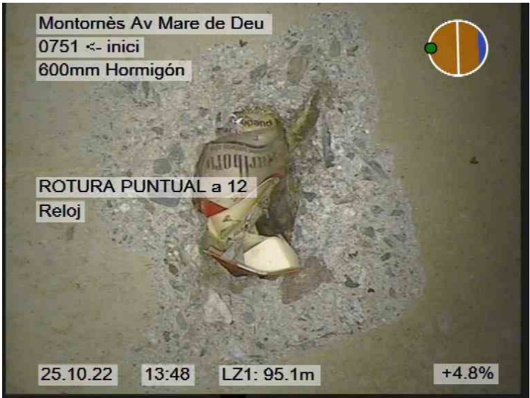
13.jpg, 00:09:09, 95.10m ROTURA PUNTUAL a 12 Reloj
