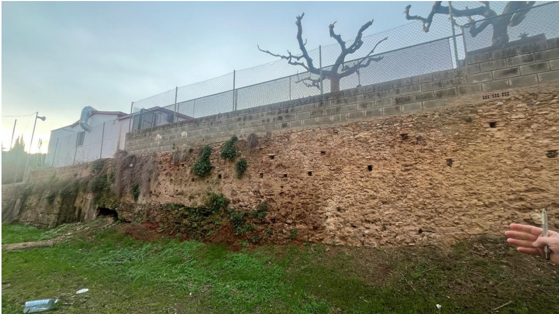
Vista frontal del mur, presència d'humitats, vegetació, erosions locals, etc...
