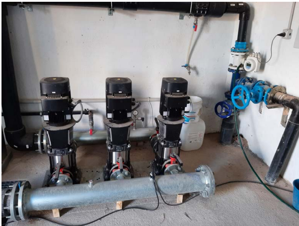
13 Caseta del dipòsit Grup de pressió de la canonada de sortida de dipòsit a xarxa de distribució a controlar.
