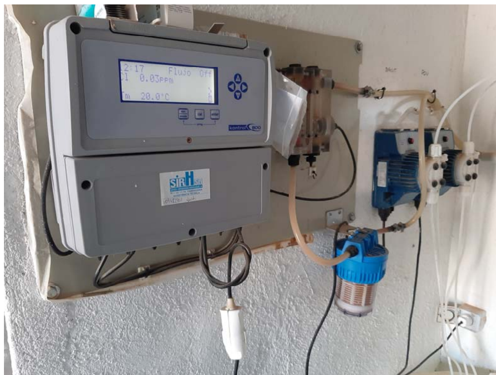
12 Caseta del dipòsit. Equip de dosificació de clor a controlar.
