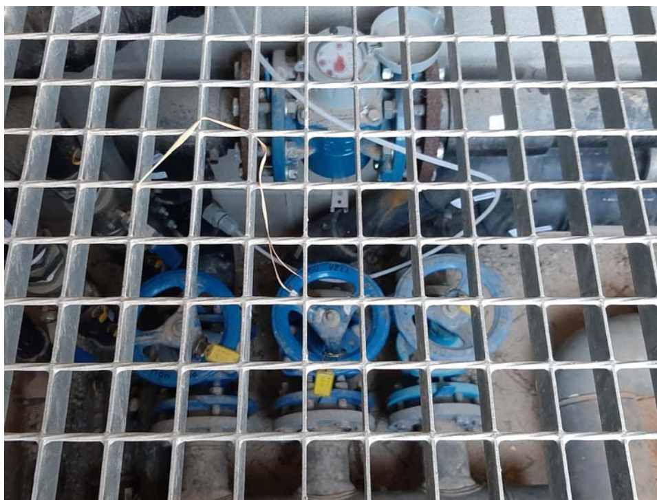
11 Caseta del dipòsit. Detall d'arqueta del col·lector de les canonades d'entrades i de comptador a controlar.
