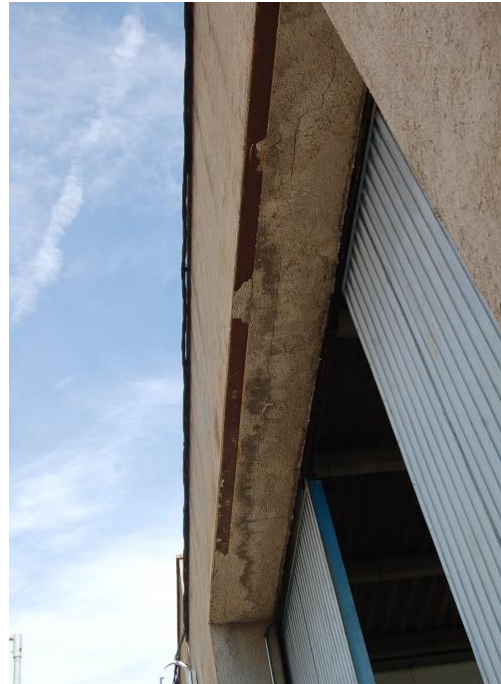
Estat llinda entrada Nau 2
