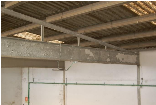
Estat de la pintura de l'estructura Nau 1
