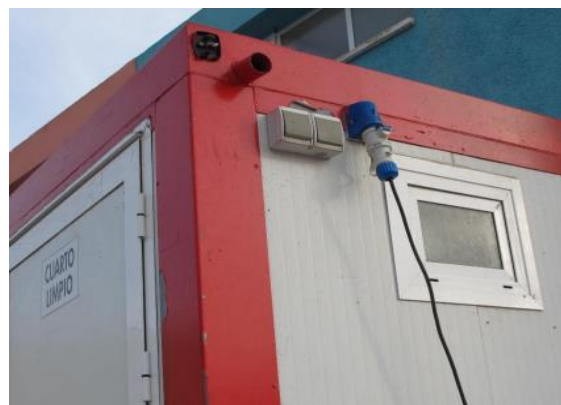
Connexió de la UMD a la xarxa elèctrica
