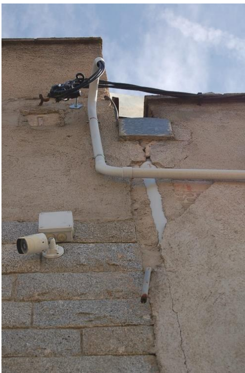
Detall patologia façana
