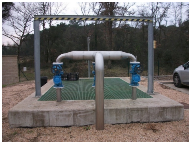
Foto 33: Vista general del pou dessorrador de l'EDAR Terrafortuna
