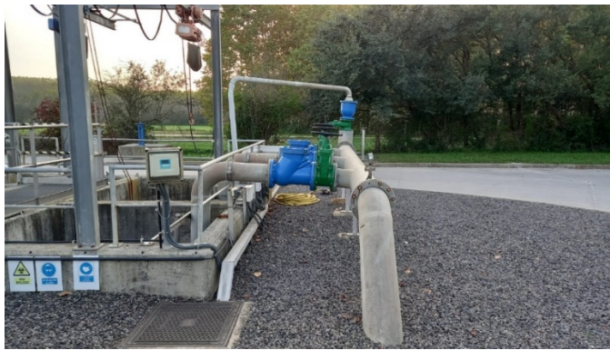
Foto 48: Vista exterior del pou d'entrada amb la sortida de les impulsions de les bombes i el col·lector
