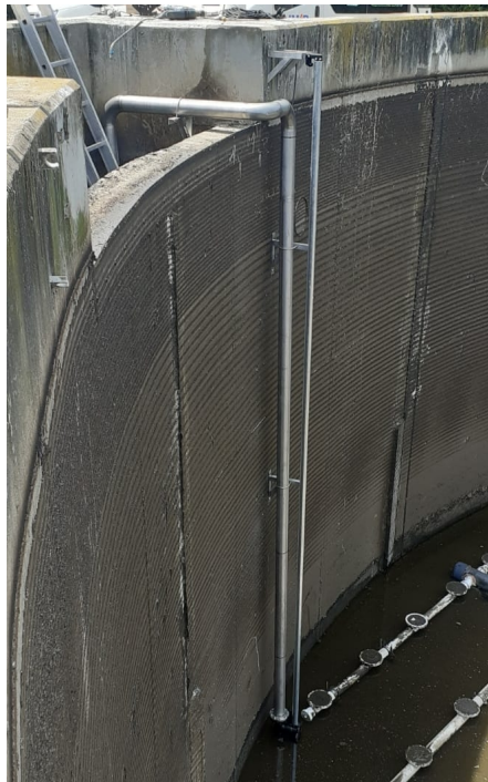
Foto 40: Exemple de muntatge de bombes de buidatge a l'EDAR d'Anglès
