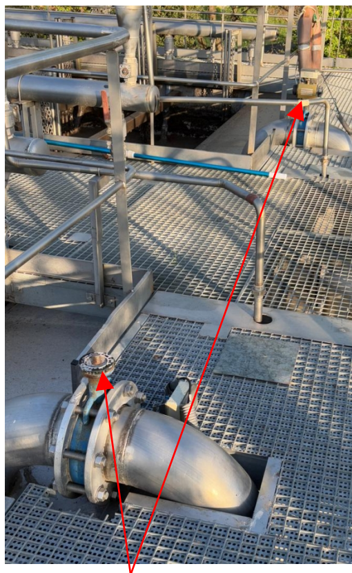
Foto 42: Vista de les 2 vàlvules de la purga
