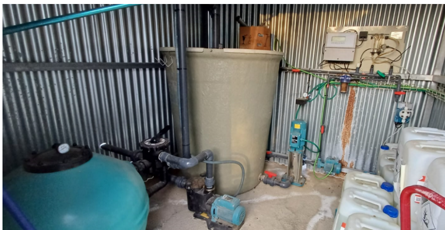
Foto 10: Caseta de l'equip de cloració de l'aigua de servei
