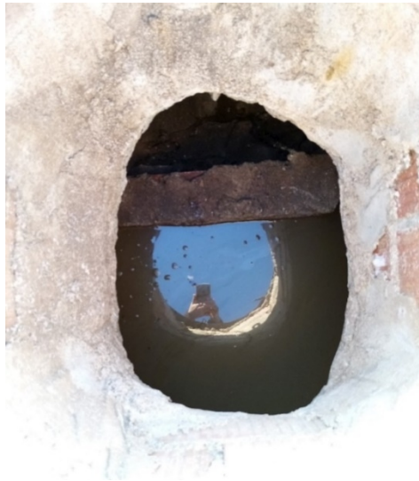
Foto 6: Sobreeixidor de l'EBAR Mallorquines (TM Sils)
