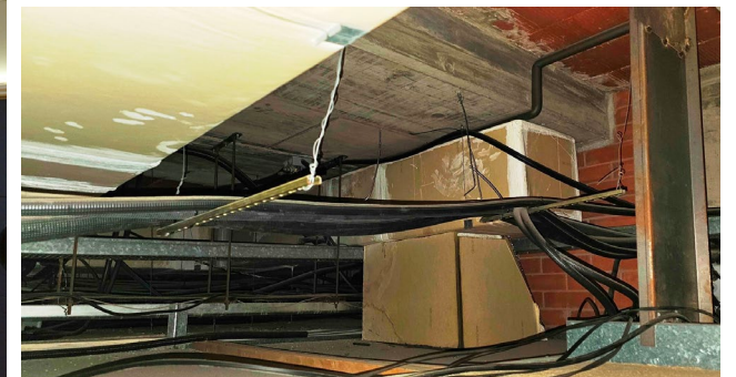
Instal·lacions ubicades entre el fals sostre i el forjat
