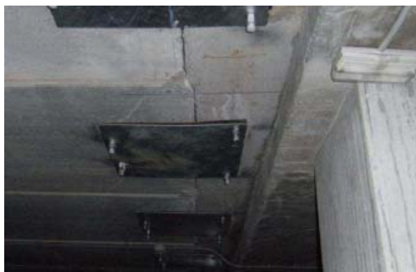
Imatge 2: Fissura existent (2018).
