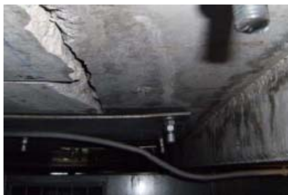
Imatge 3: Detall de les fissures entre nervi i placa (2018).
