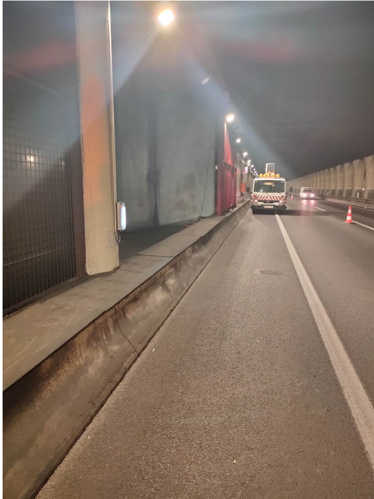
Imatge 13. Exemple d'entrada a sala tècnica a mantenir l'accés.
