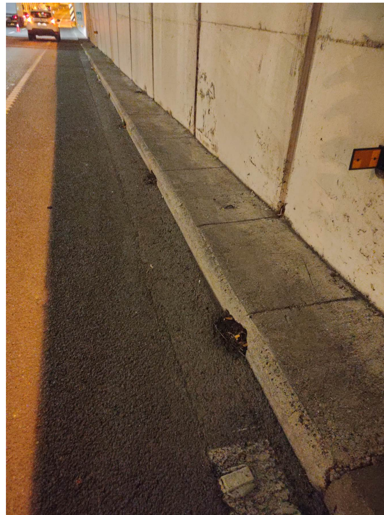
Imatge 2. Detall d'embornals i canalització sota la vorera lateral de la B-10.
