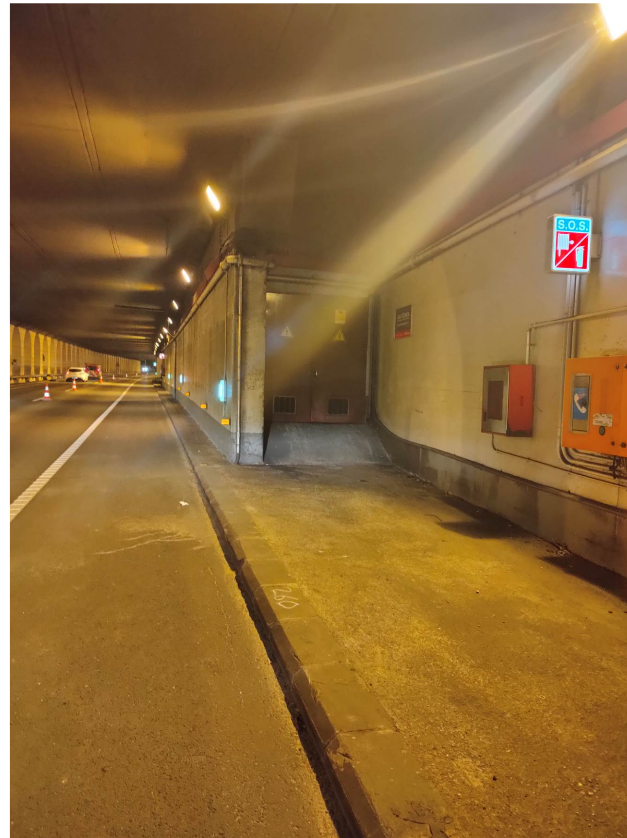
Imatge 8. Exemple de sala tècnica de túnel de Rondes.
