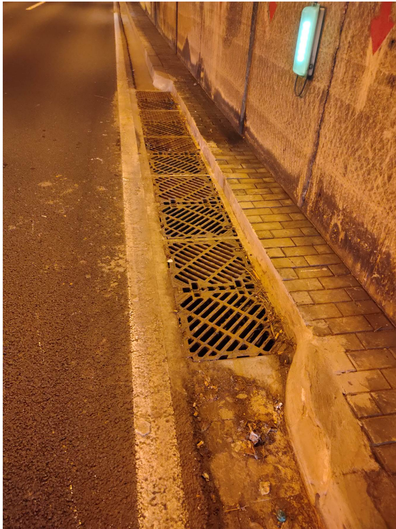
Imatge 15. Detall d'actuacions sobrevingudes no contemplades a l'aixecament topogràfic.
