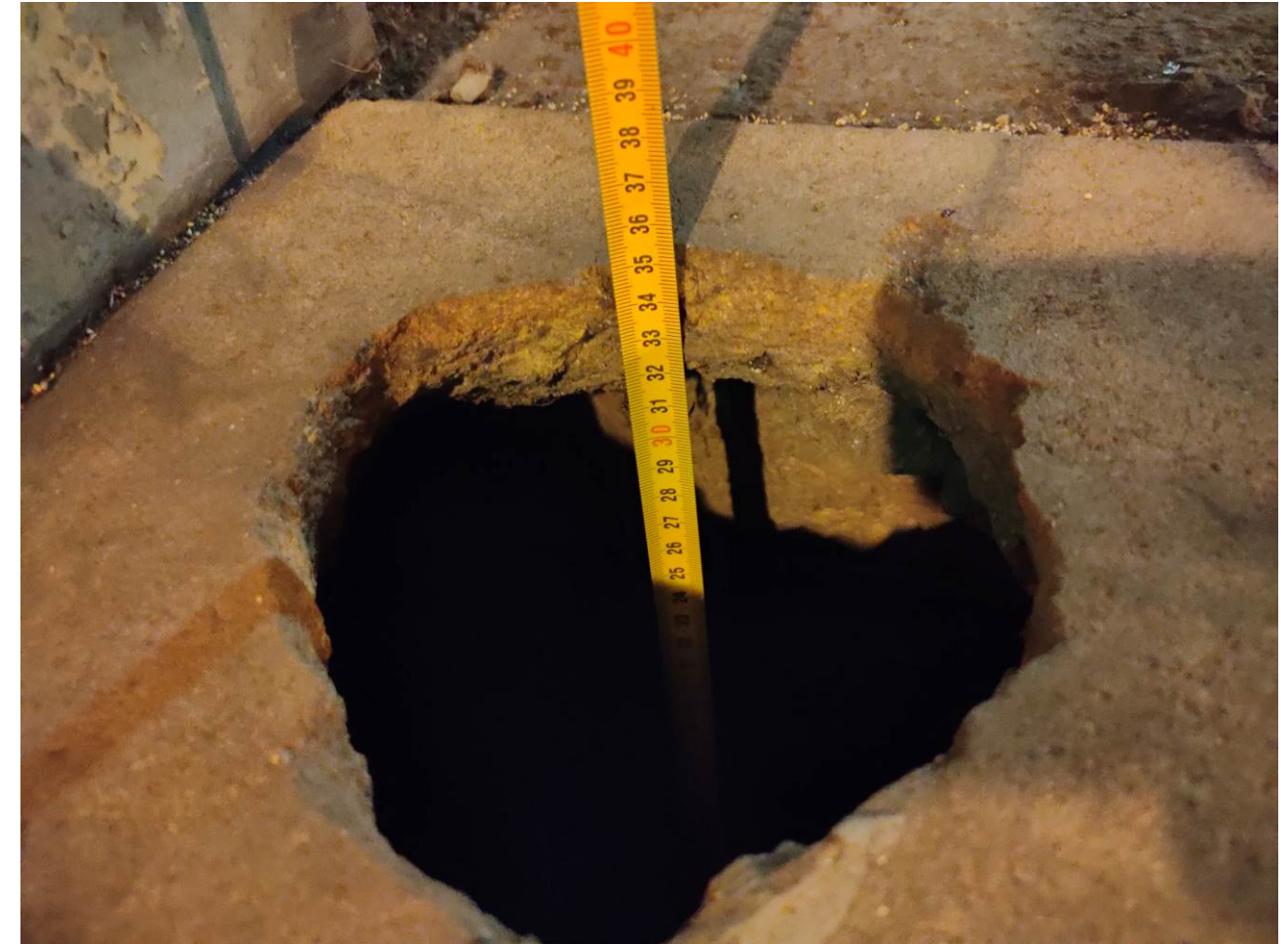
Imatge 4. Trencament de la tapa de canalització de clavegueram i mesura.
