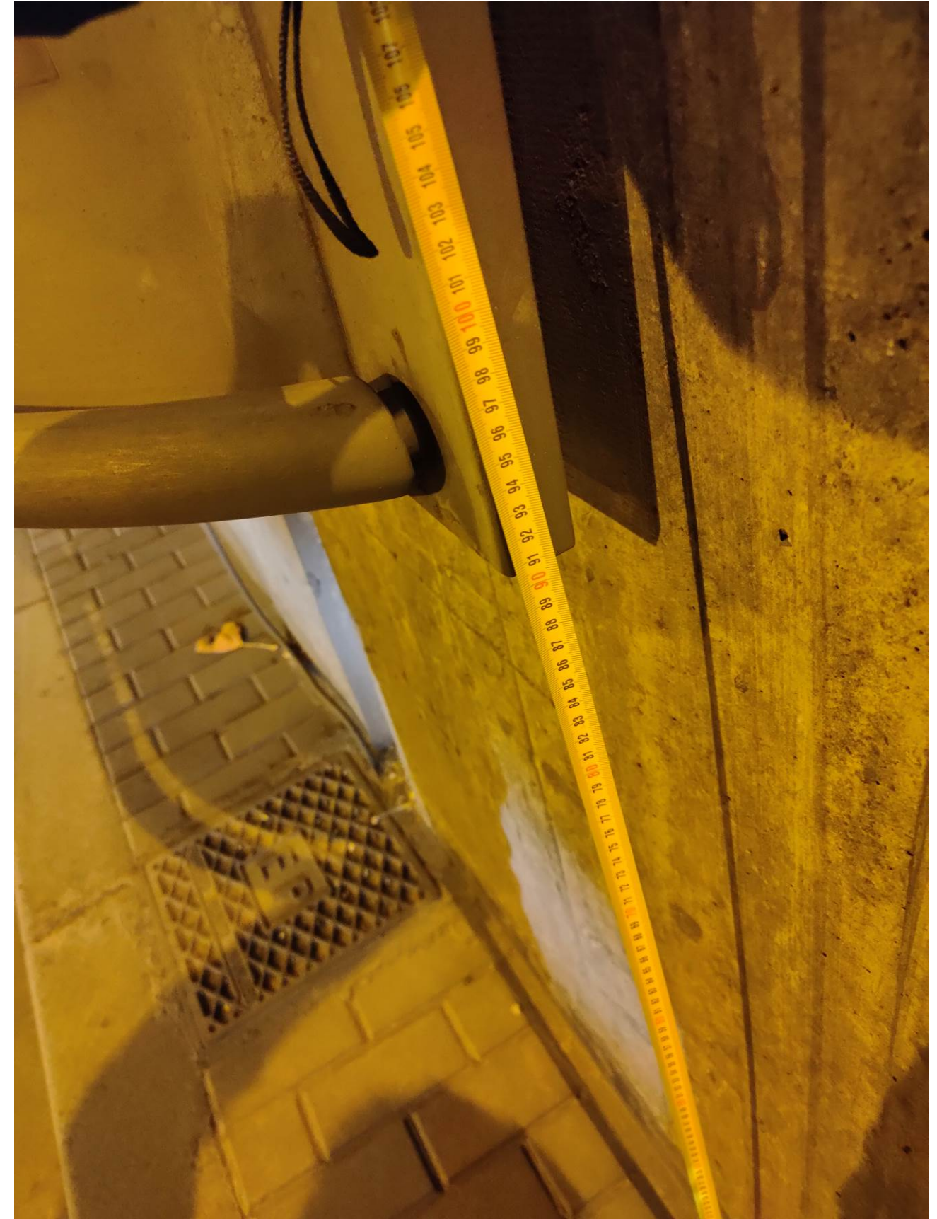
Imatge 14. Replanteig d'alçada de BIE's existent.
