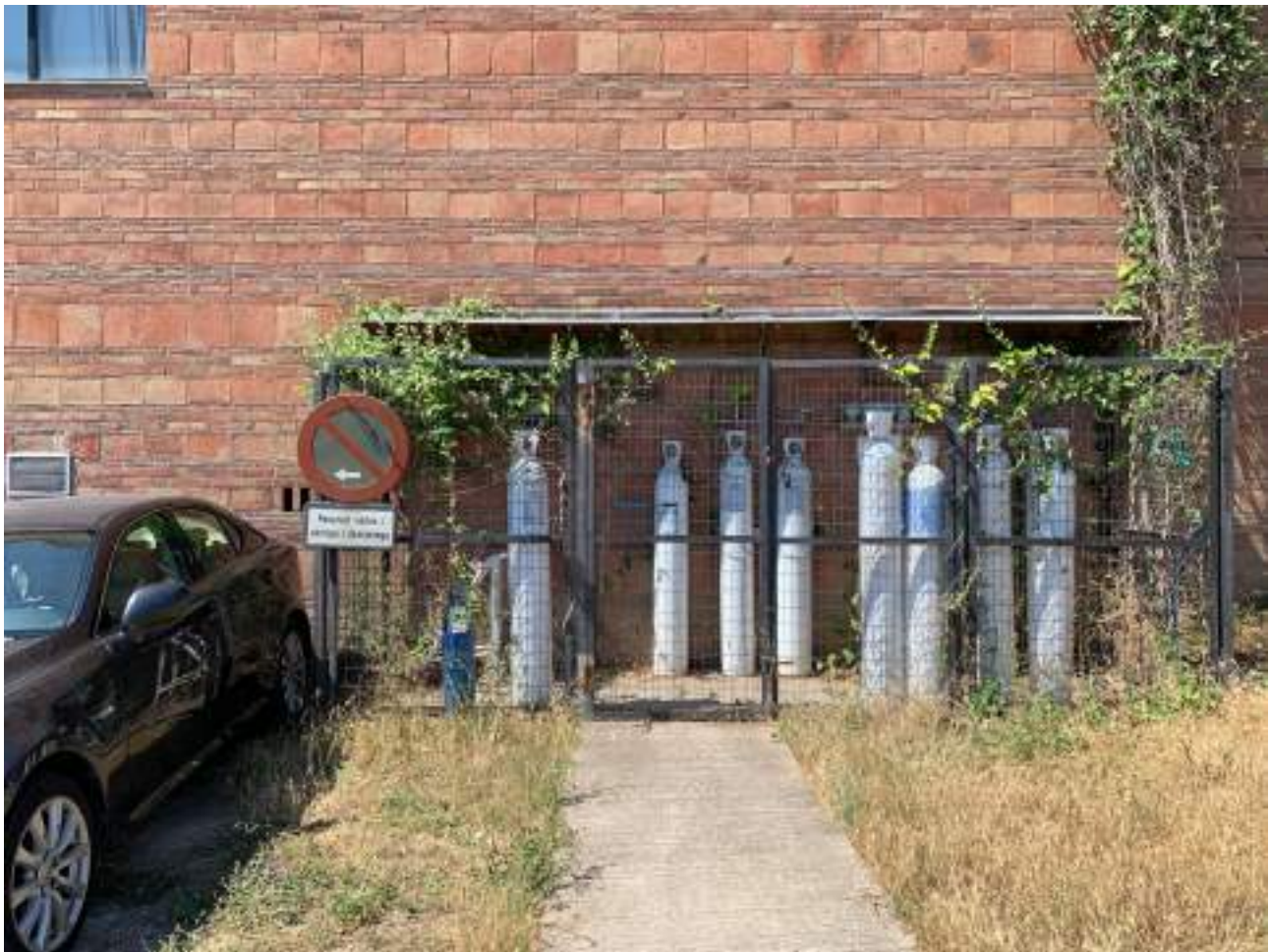
Recinte exterior d'emmagatzematge de gasos.
