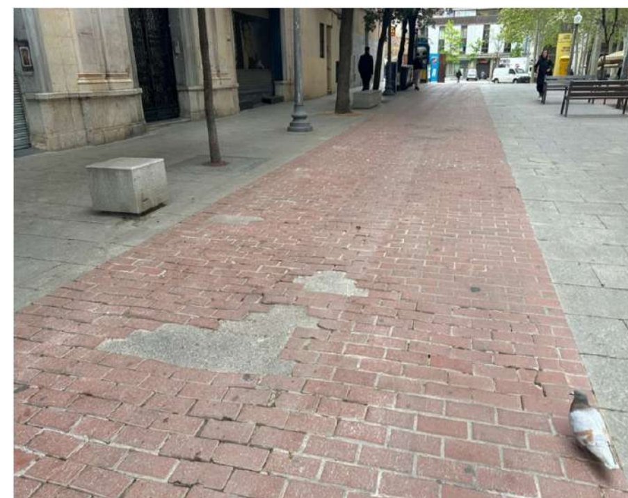
8. Desperfectes al paviment, àmbits trencats reblerts amb formigó/asfalt
