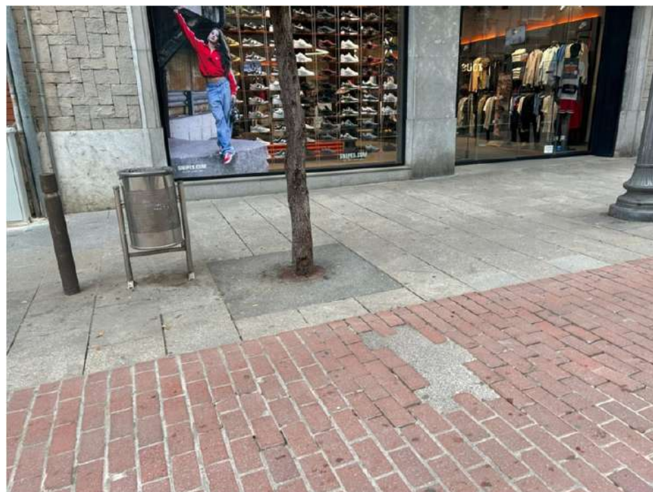
2. Desperfectes al paviment, àmbits trencats reblerts amb formigó/asfalt
