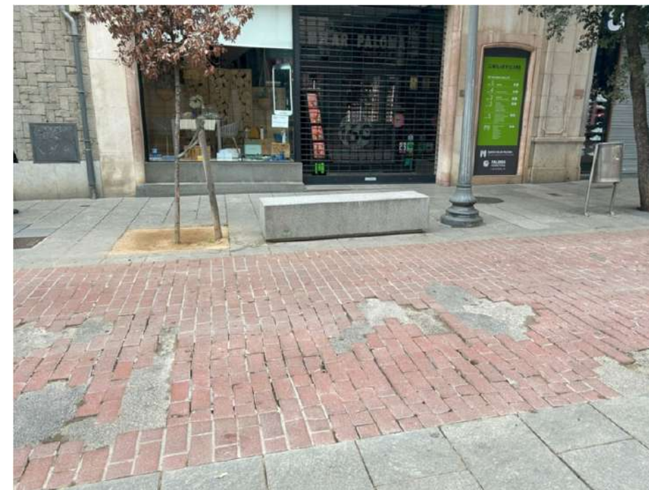
7. Desperfectes al paviment, àmbits trencats reblerts amb formigó/asfalt
