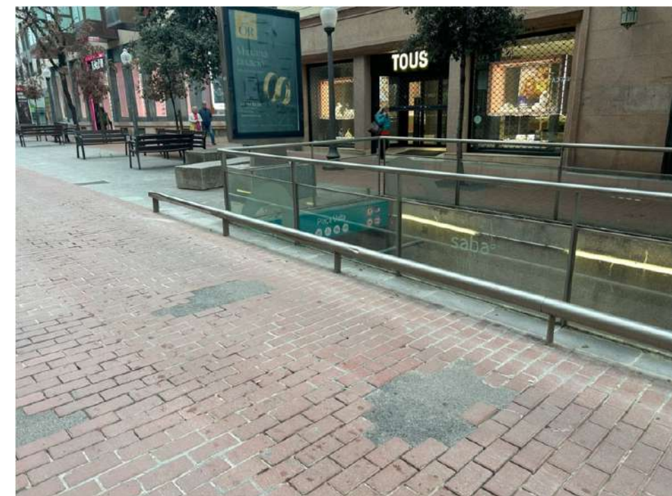
4. Desperfectes al paviment, àmbits trencats reblerts amb formigó/asfalt
