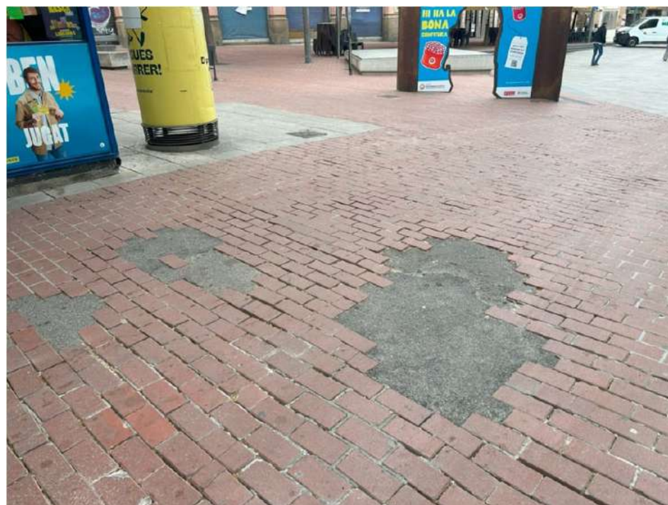
10. Desperfectes al paviment, àmbits trencats reblerts amb formigó/asfalt
