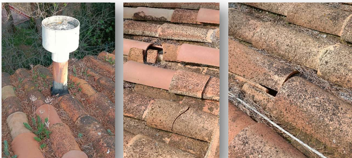
Imatge de la presència de plantes a la coberta i de teules trencades
