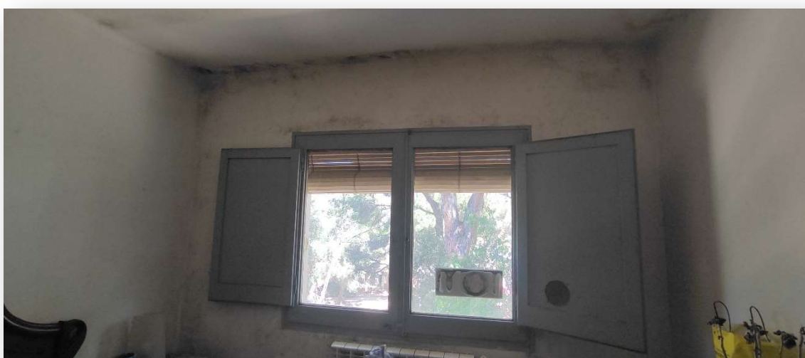
Imatge de la presència d'humitats a una de les habitacions de la planta primera.
