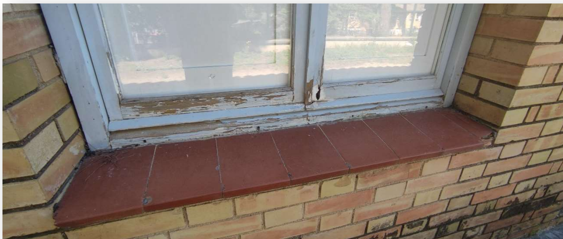
Imatge d'una de les fusteries originals de fusta en mal estat de conservació.
