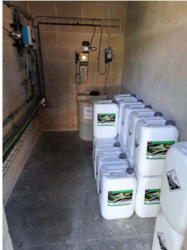
13. Sala de dosificació d'hipoclorit
