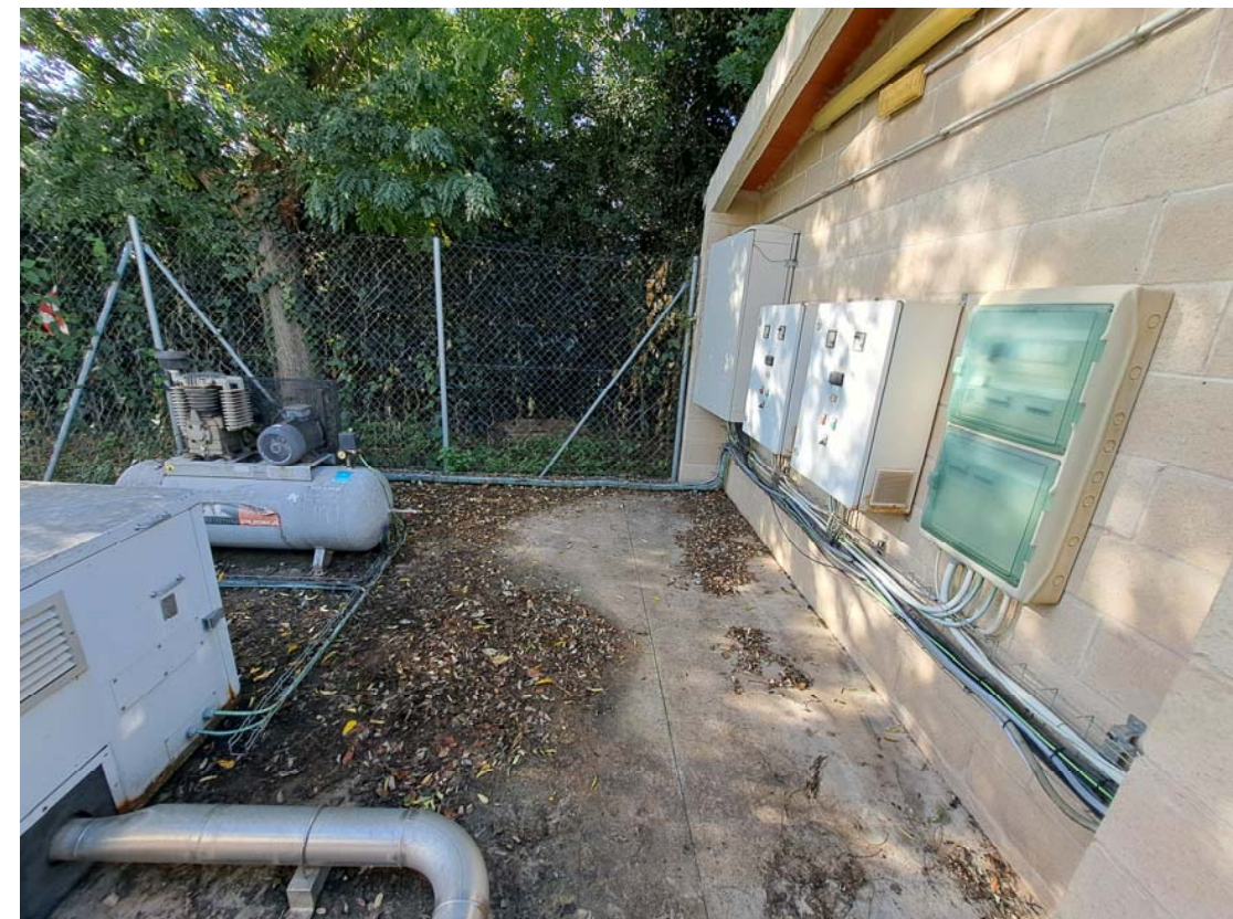
16. Bufador, compressor i quadres elèctrics de la filtració existent
