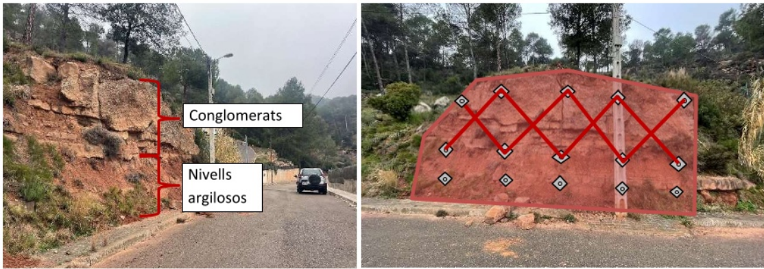
Fig. 28. Talús inestable al sector B (esquerra) i actuació directa AD2 il·lustrativa amb geomanta reforçada i quadricula de bulons i cables d'acer encreuats (dreta).
