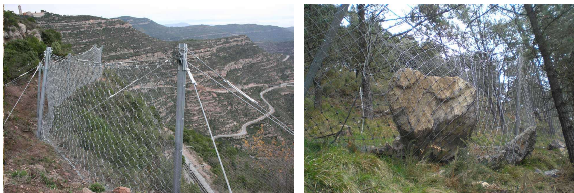
Fig. 25. Exemple de barreres dinàmiques per a la protecció de talussos per desprendiments.
