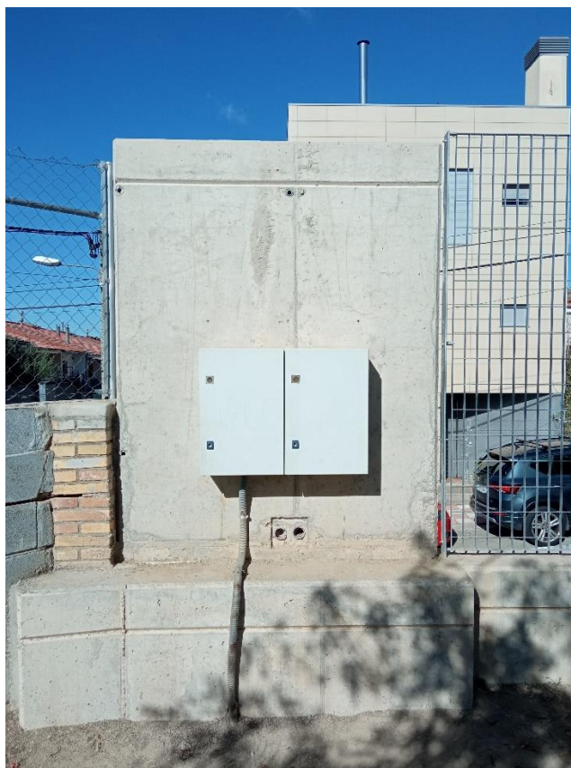
Figura 3. Ubicació de l'armari tècnic
