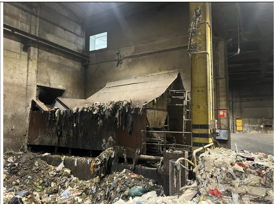
Alimentador existent línia FORM.
