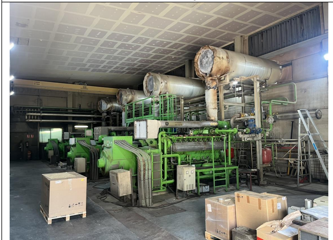
Motors de cogeneració existents
