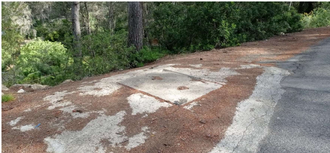
Imatge de l'arqueta de la captació d'aigües subterrànies actual (Foto: maig de 2025)
