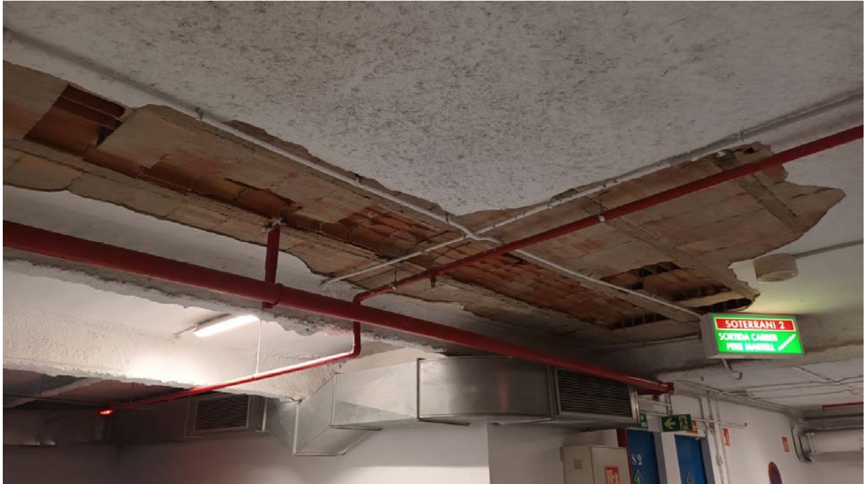
Despreniments de la Zona 1
