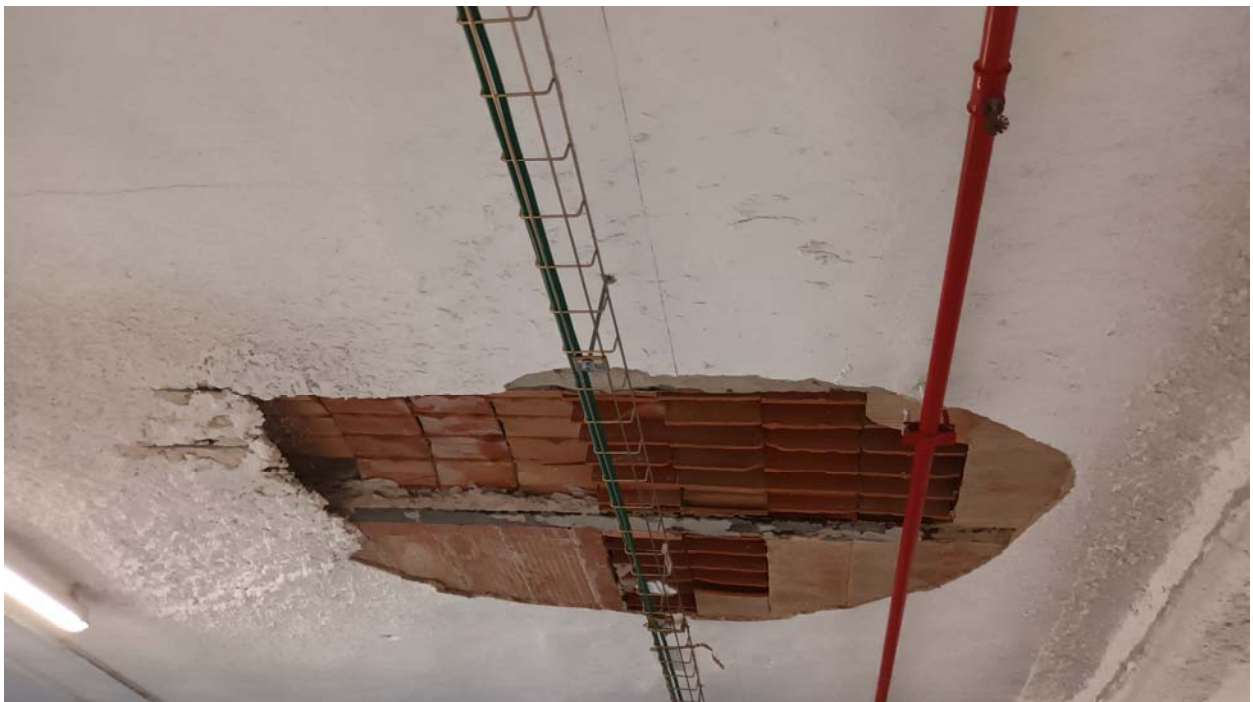
Despreniments de la Zona 2
