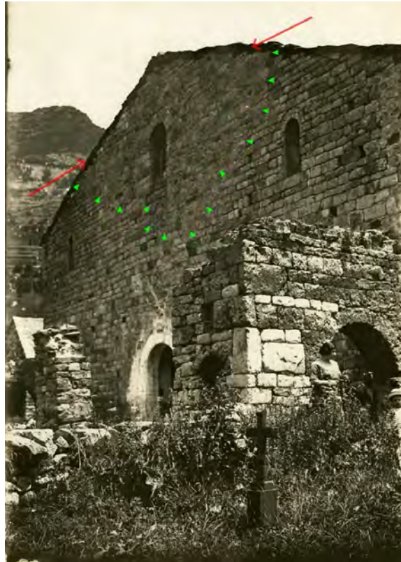
Traces de reparació a la façana occidental. En verd, una intervenció al voltant de l'obertura de la finestra, amb maçoneria irregular; per sobre de les fletxes vermelles, una altra actuació de regularització amb carreus granítics (Foto: J. Vidal Ventosa, 1920; AFB)
