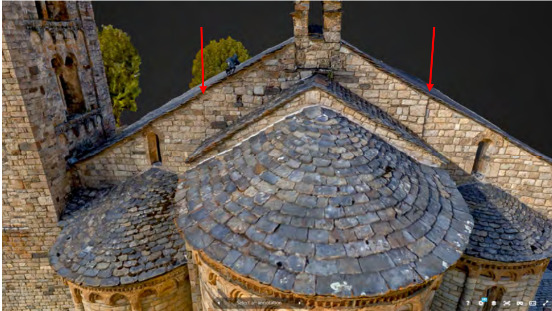
Imatge del coronament de la capçalera amb indicació de les juntes constructives (fletxes vermelles), indicatiu de què les naus laterals s'haurien adossat a la nau central durant la Fase III (Foto: Giravolt)
