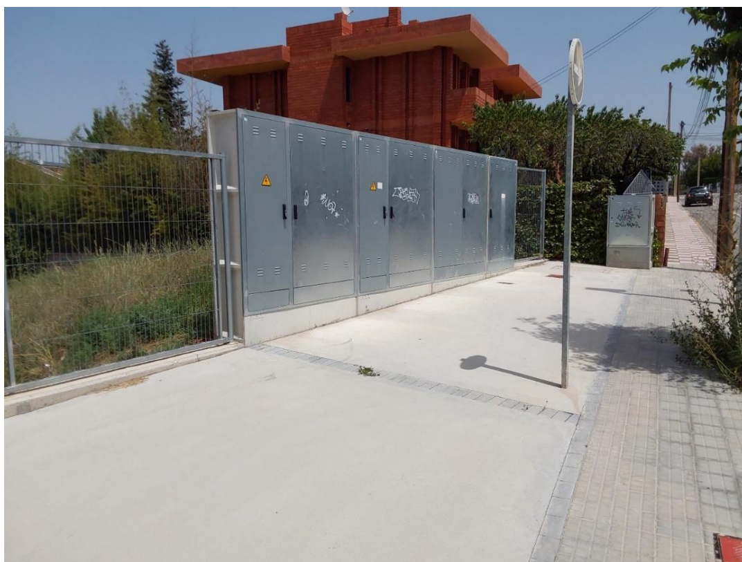
Instal·lació d'enllaç. Vista general
