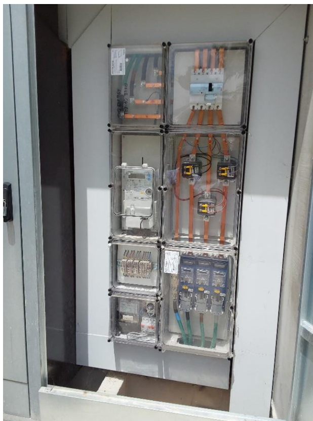
Instal·lació d'enllaç. TMF10
