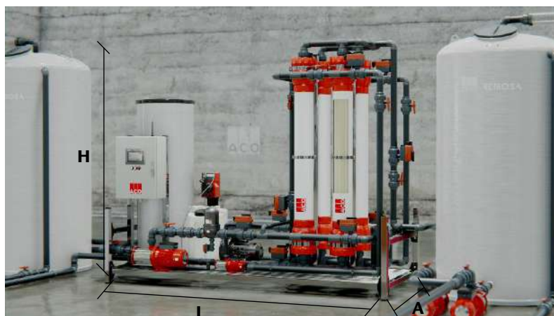
Depósito/s pulmón de aguas grises
